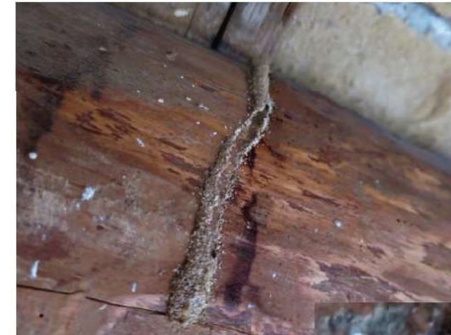
Canal de trànsit dels tèrmits subterranis
