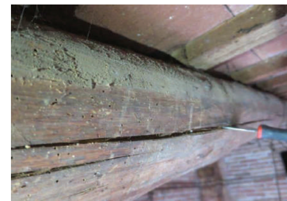
Figura 2.1 Bigueta de fusta del sostre de la planta primera amb una clivella significativa en el pla inclinat.
