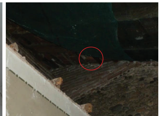
Figura 3.2 Forat a la coberta de la finca que ha provocat la filtració d'aigua dins d'aquesta.
