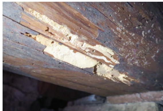
Figura 2.4 Degradació superficial de la biga del sostre de la planta primera causada per corcs de gran mida.
