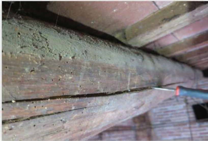
Sostre de la planta 1 (P1). Element P1C2. Imatge 376 Clivells significatius en el pla inclinat
