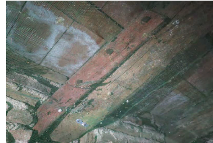
Figura 2.6 Degradació causada per fongs de podriment d'una biga del sostre de la planta primera.
