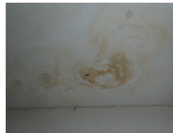
Figura 3.1 Humitat present en el sostre de la planta primera, provocada per filtracions de la coberta.
