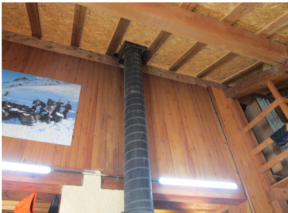
Imatge 03: Tub evacuació fums actual
