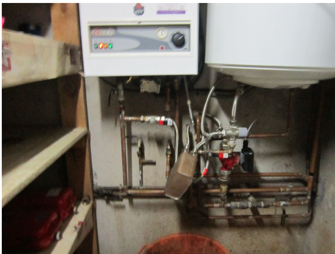
Imatge 05: caldera i acumulador actual
