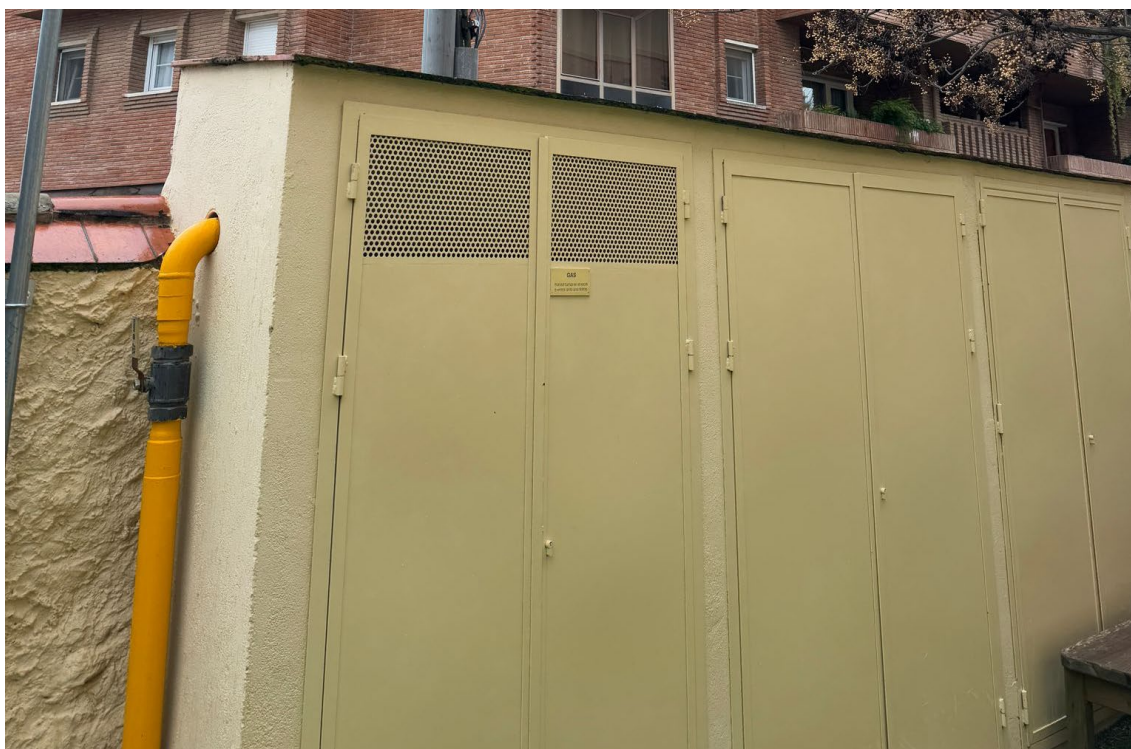
Imatge 17: Armaris existents i espai (a la esquerra) on s'ubicarà els nou armaris de la fotovoltaica.
