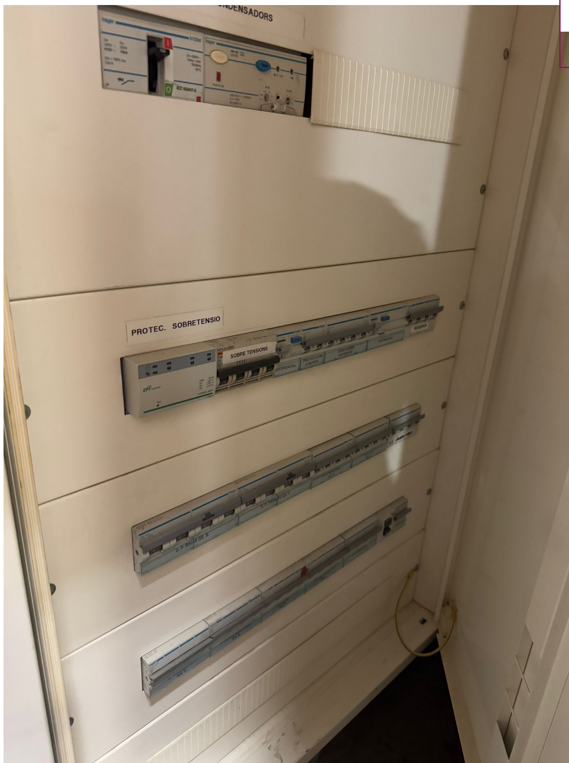
Imatge 22: Detall de quadre elèctric general de l'edifici el qual ja disposa de protecció contra sobretensions
