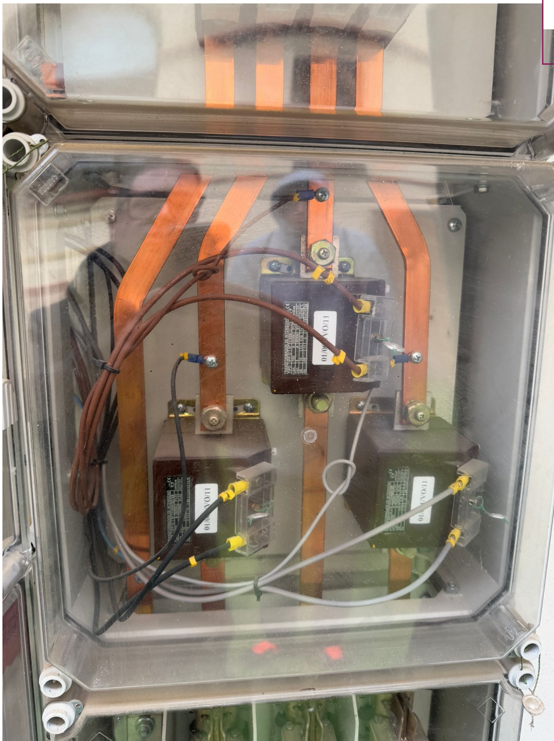
Imatge 26: Detall dels transformadors d'intensitat de la TMF10 existent de consum de l'escola
