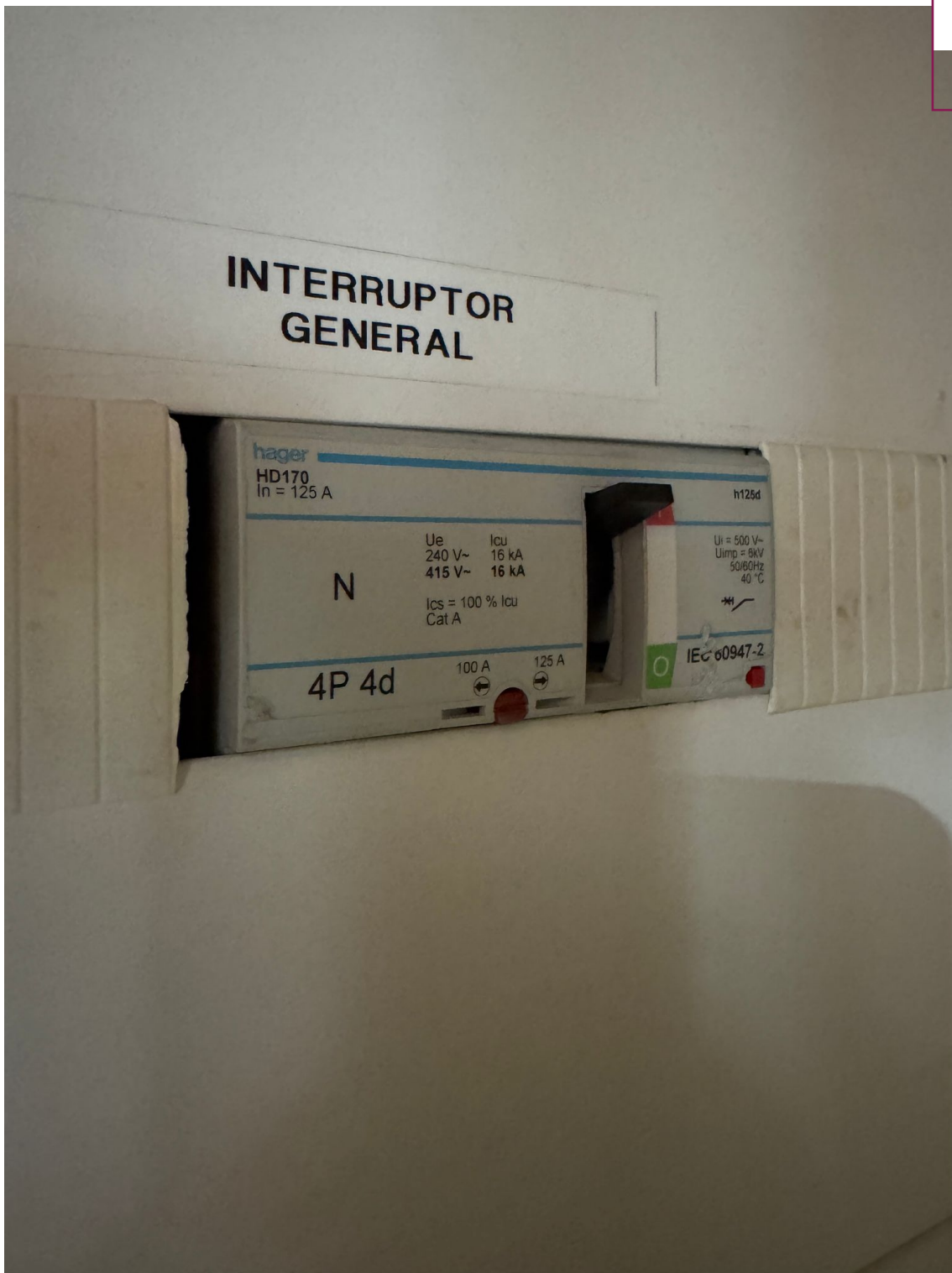
Imatge 23: Interruptor general de l'edifici de l'Escola Garcia Fossas
