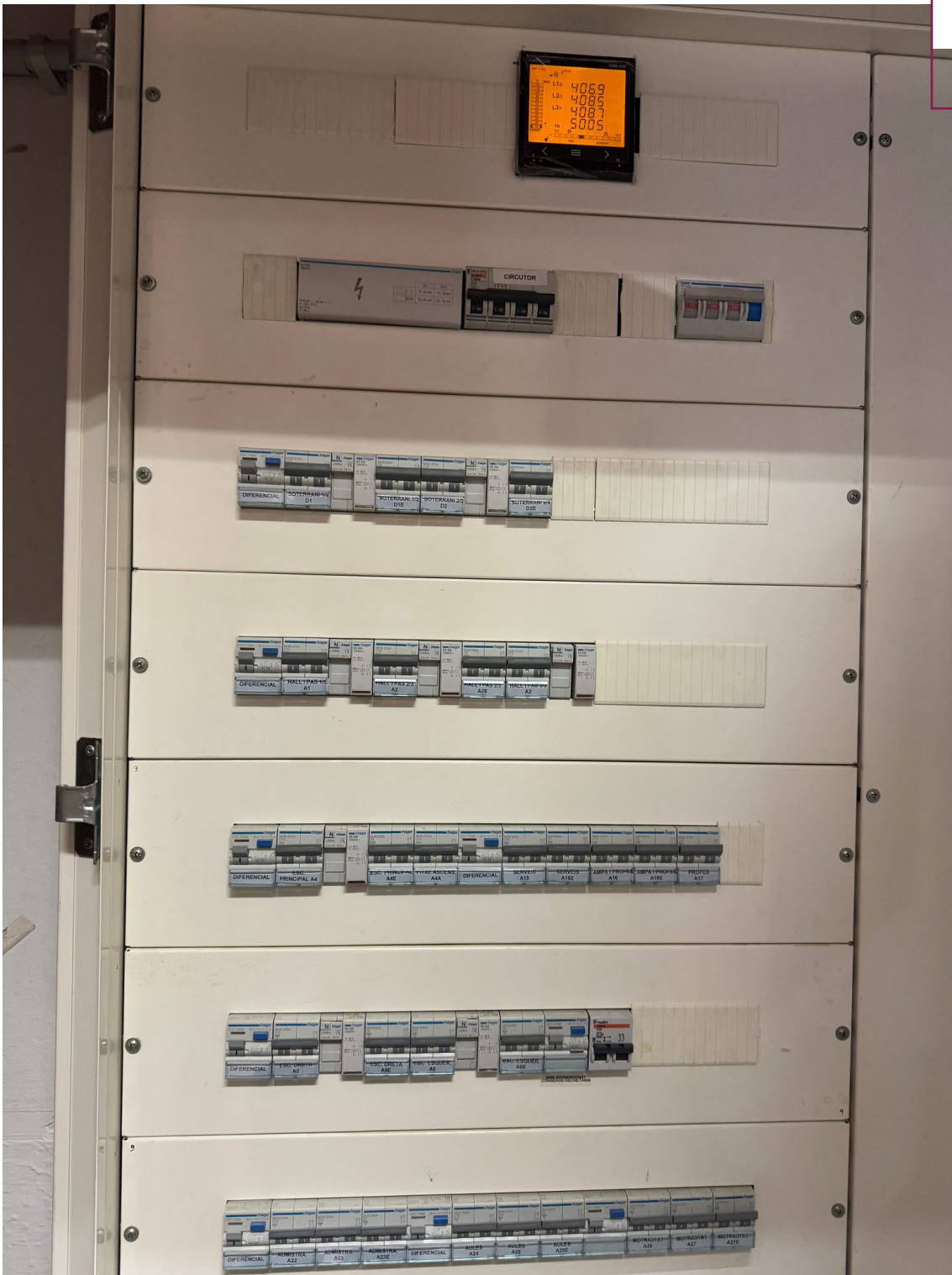
Imatge 21: Quadre elèctric general de l'edifici del CEIP GARCIA FOSSAS
