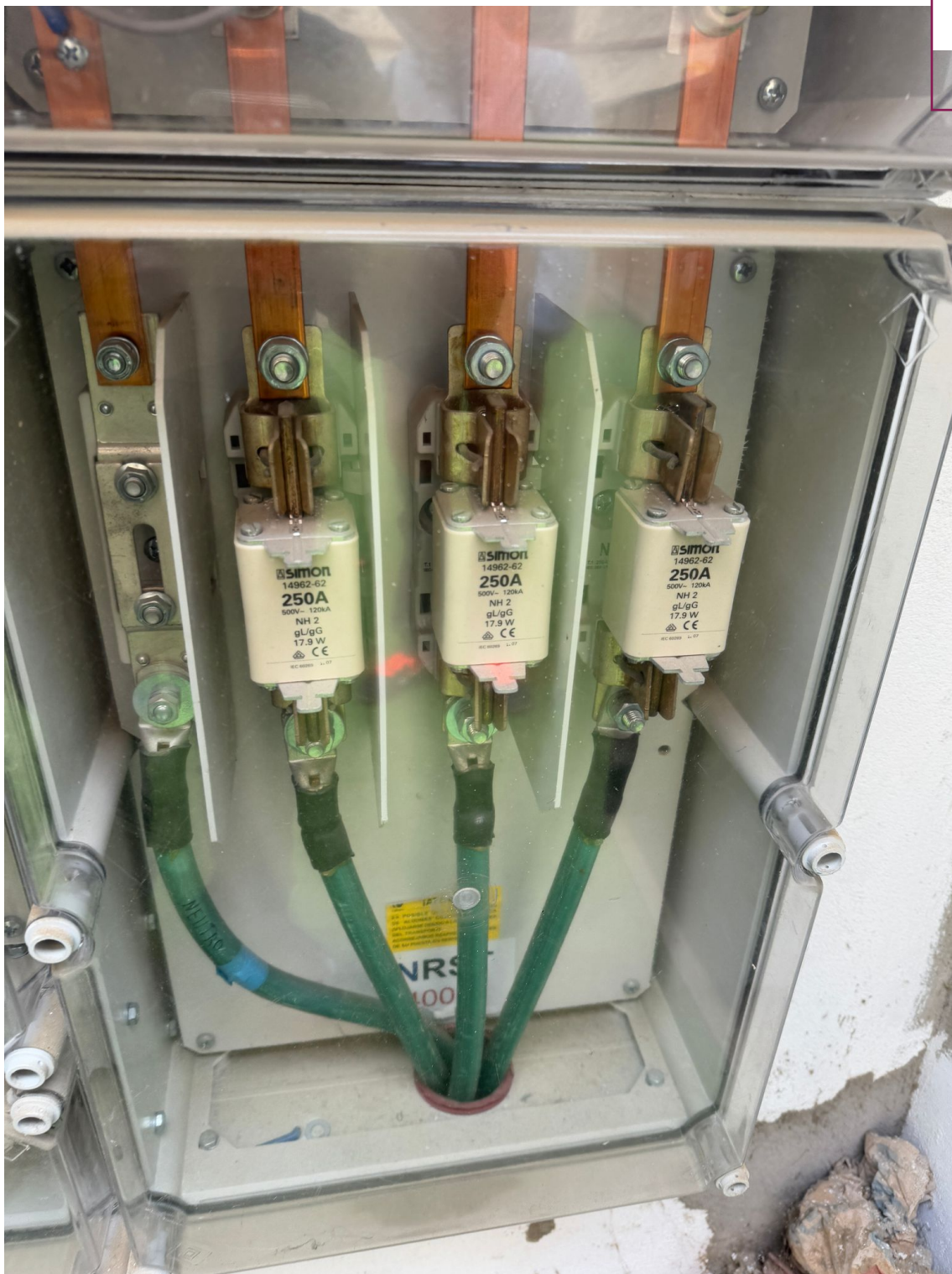
Imatge 27: Detall dels fusibles (no tipus BUC) de la TMF10 existent de consum de l'escola
