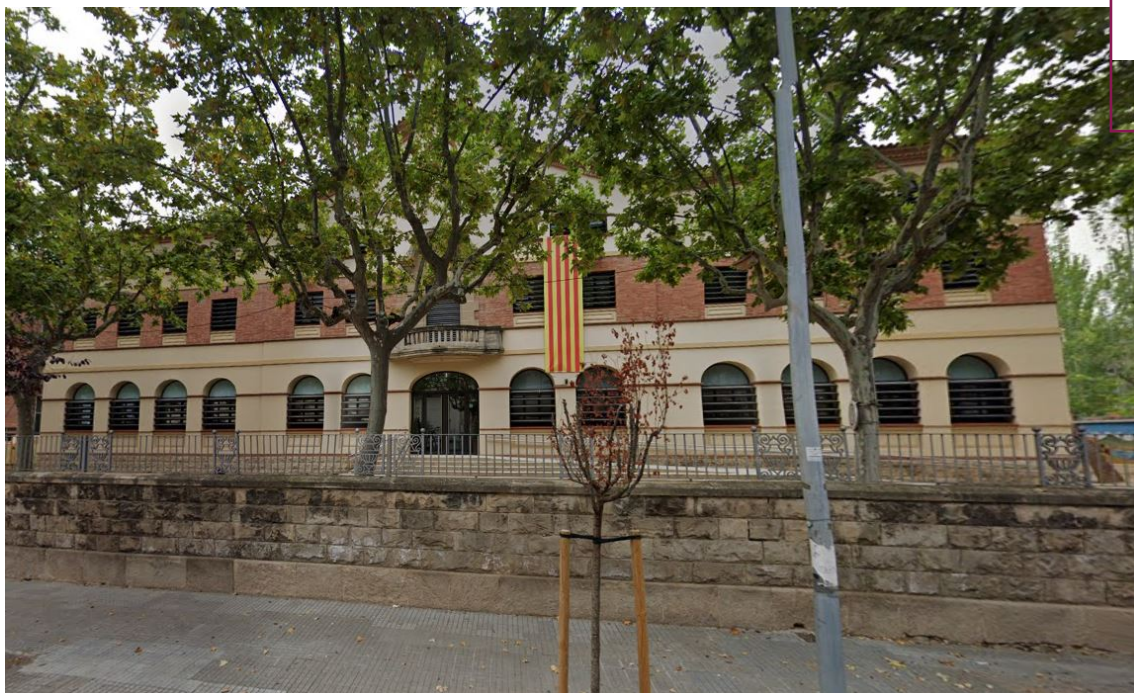
Imatge 2: Imatges de la coberta i façana de l'edificació actual del Garcia Fossas
