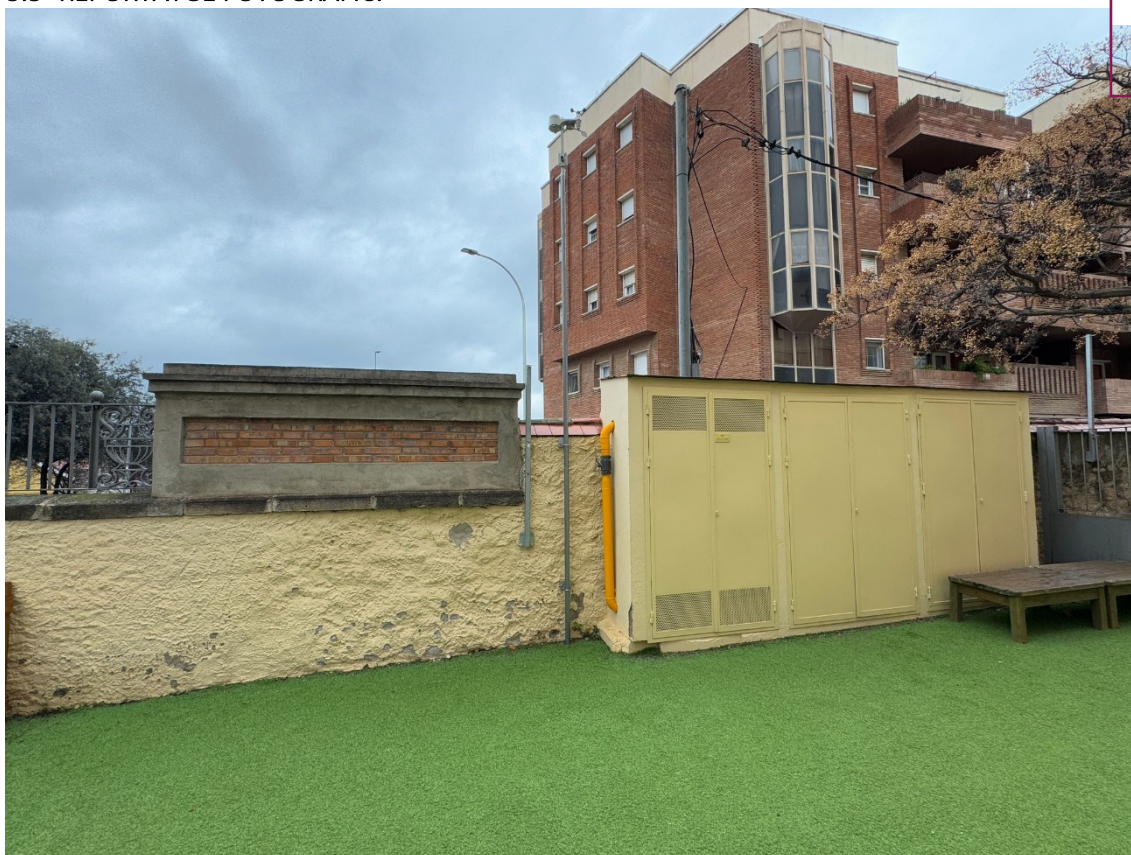
Imatge 16: Armaris existents i espai (a la esquerra) on s'ubicarà els nous armaris de la fotovoltaica.
