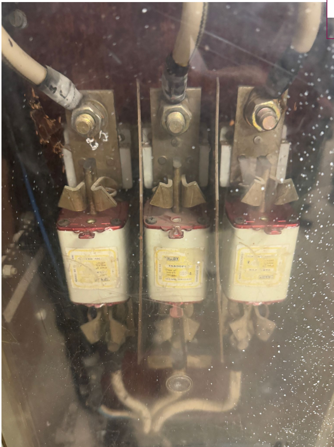
Imatge 22: Detall dels fusibles actuals de la TMF10 de consum del centre
