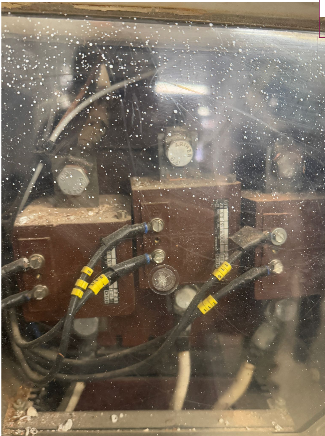
Imatge 23: Detall dels transformadors d'intensitat de la TMF10 de consum del centre
