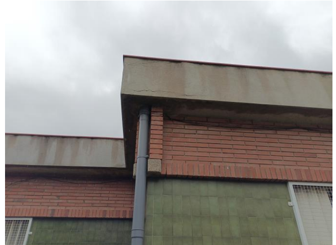
FOTO 4 Detall de l'ampit de coberta que presenta algunes fissures en l'arrebossat d'acabat
