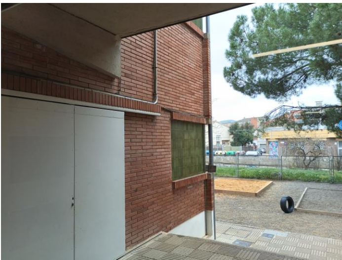
FOTO 7 Detall de la coberta de l'accés al pati on es detecta alguna fissura o esquerda a l'acabat que pot indicar oxidació d'armats per falta de manteniment a la part inferior del sostre
