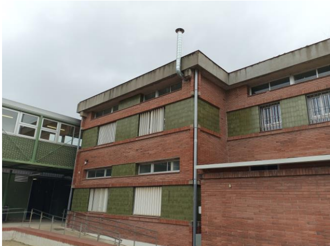
FOTO 3 Detall de la façana principal de l'edifici i la connexió amb la pasera de la planta primera
