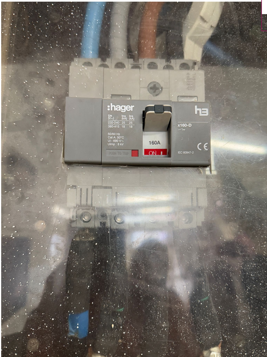
Imatge 20: Interruptor general de seccionament a la TMF10 actual de consum
