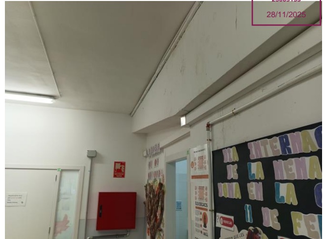
FOTO 6 Detall de l'interior de l'edifici principal a nivell de planta primera on es repeteix l'esquema estructural de la planta inferior
