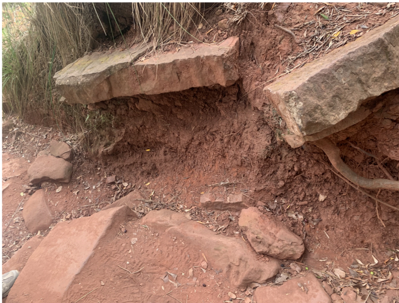
Erosió causada per l'escorrentia de l'aigua de pluja Font: Roger Guitart i Domingo
