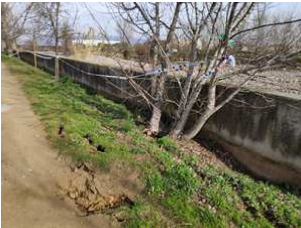
Fig. 1,2 i 3 – El meandre del riu va avançar eliminant totes les terres de la zona del mur i el va soscavar per sota, fins al punt que el terreny del passeig fluvial va cedir. Aquí es va actuar a temps, però en d'altres indrets va sortir un forat de 2-3 metres de fondària, 10 m de llargada i 4 d'amplada.
