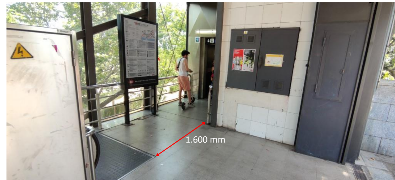
Il·lustració 7. Ubicació del quadre existent i distància fins al fossat superior de les escales E3 de l'estació Trinitat Vella de línia 1
