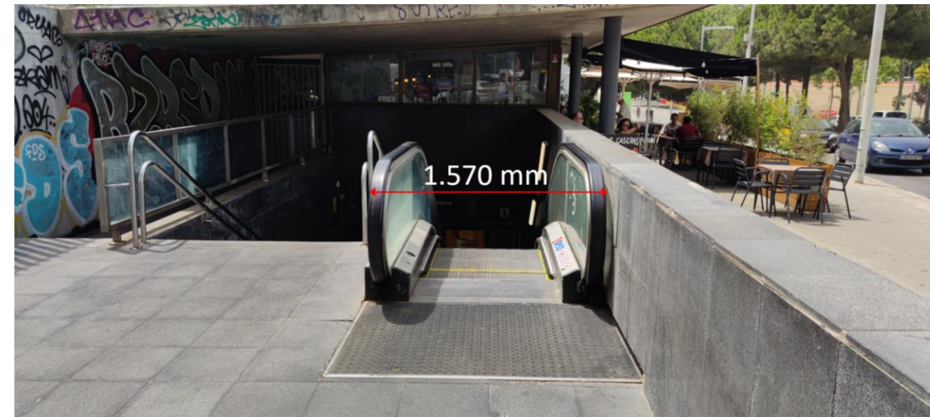
Il·lustració 53. Part superior de les escales E4 de l'estació Ciutadella de línia 4
