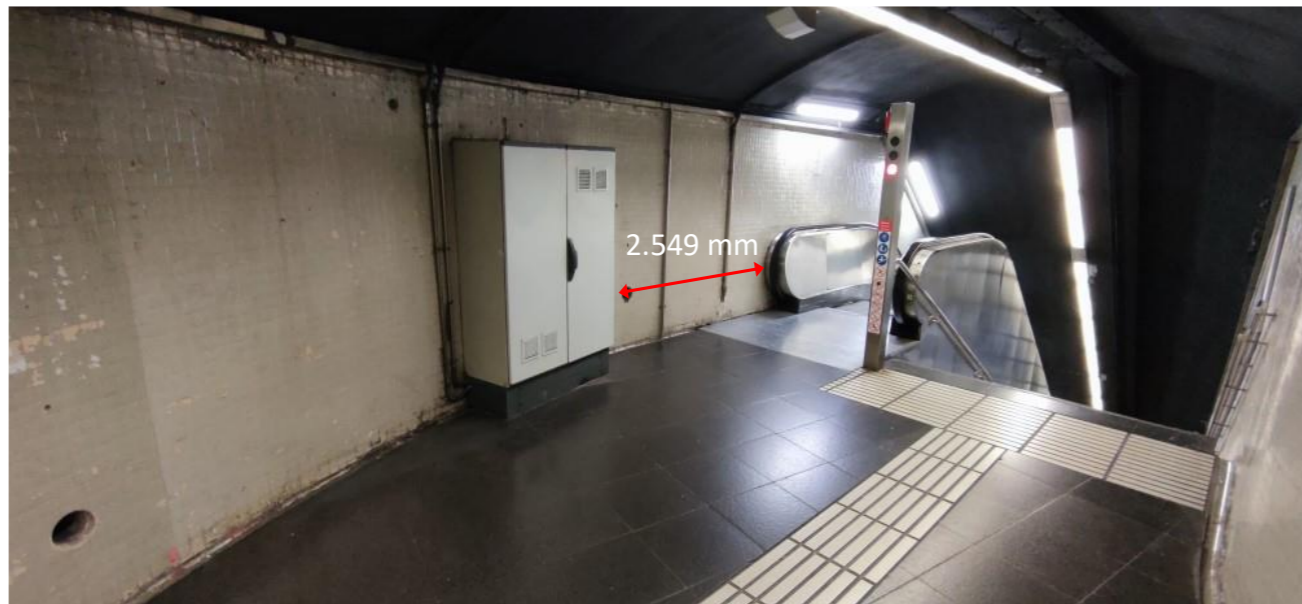
Il·lustració 34. Ubicació del quadre existent i distància fins a la part superior de la barana de les escales E1 de l'estació Lesseps de línia 3.
