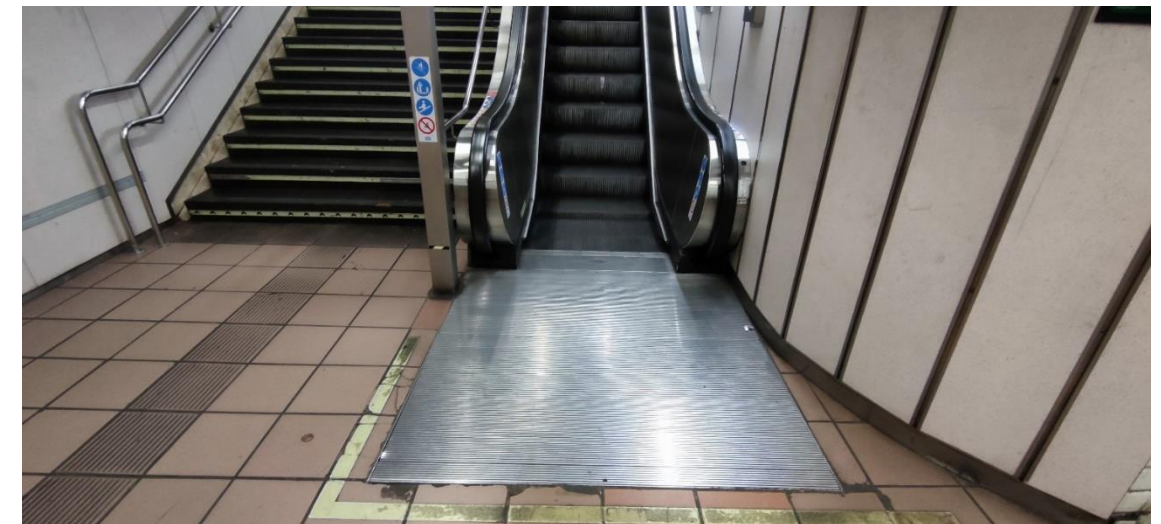
Imatge 69. Fossat de l'embarcament inferior de les escales E2 de l'estació Fontana de línia 3
