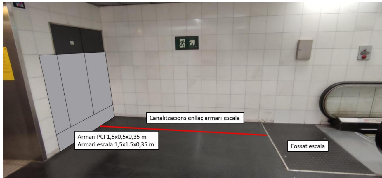
Il·lustració 12. Ubicació del nou quadre de les escales E1 de l'estació Fondo de línia 1
