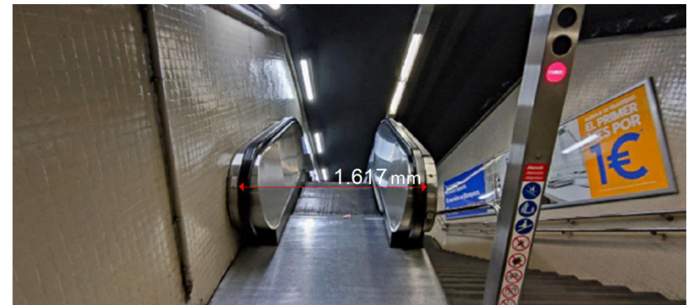
Il·lustració 32. Part superior de les escales E1 de l'estació Lesseps de línia 3
