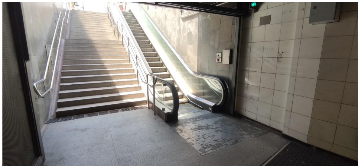
Imatge 38. Part inferior de les escales E7 de l'estació Fondo de línia 1
