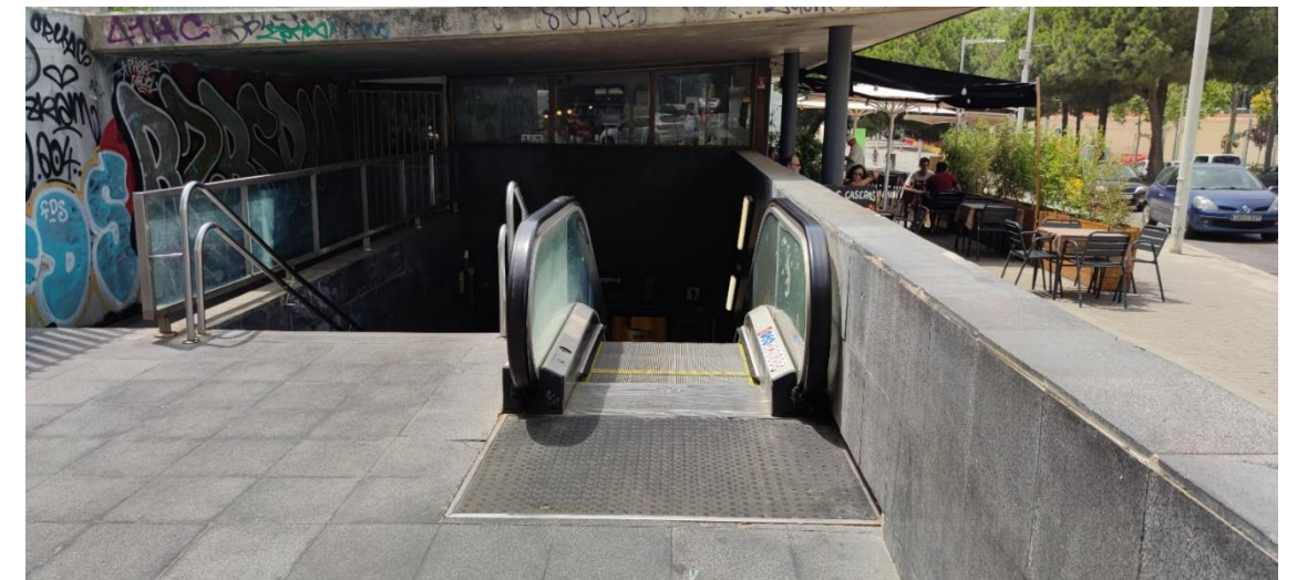
Imatge 81. Fossat de l'embarcament superior de les escales E4 de l'estació Ciutadella de línia 4
