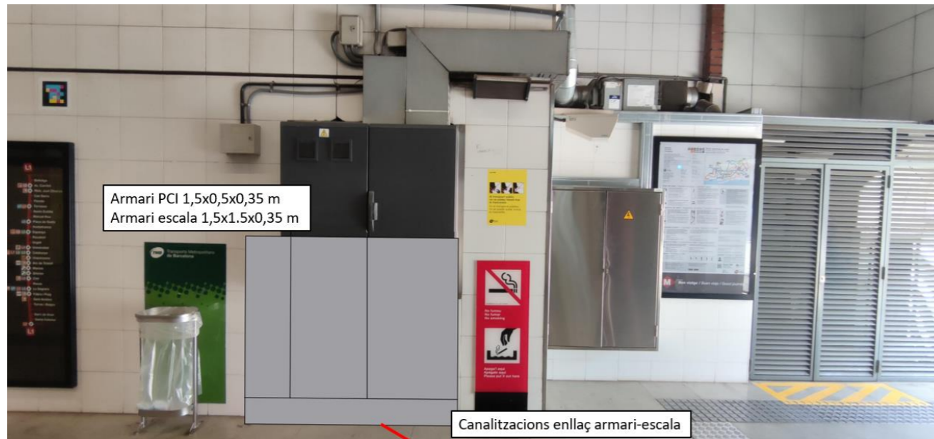
Il·lustració 4. Ubicació del nou quadre enfront del fossat inferior de les escales E2 de l'estació Trinitat Vella de línia 1
