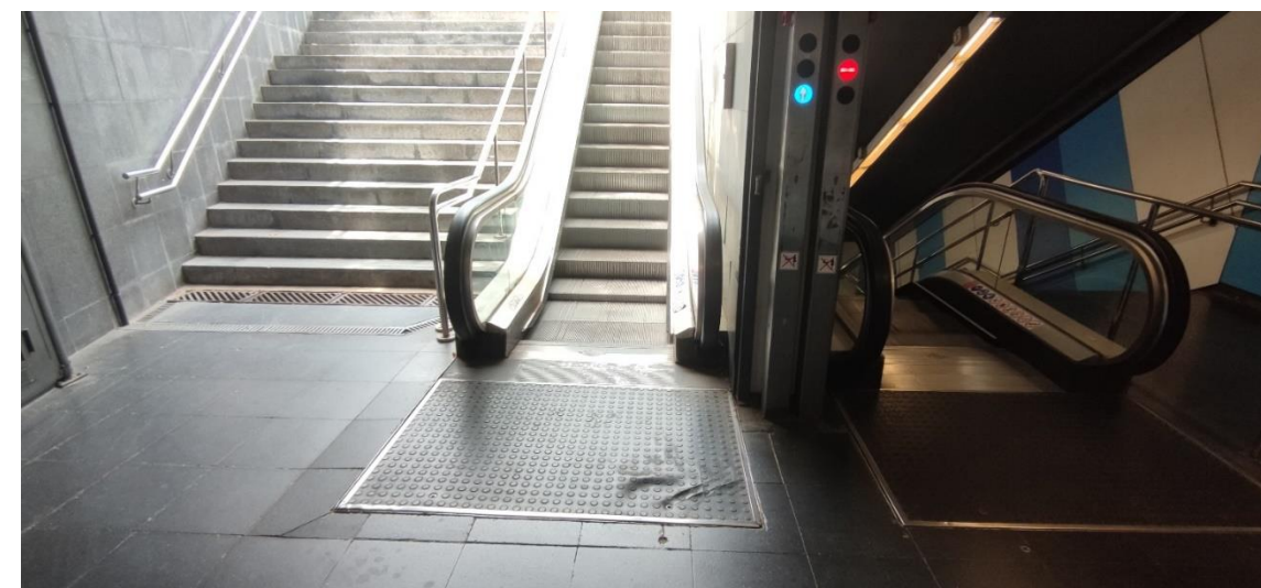
Imatge 90. Fossat de l'embarcament inferior de les escales E6 de l'estació Ciutadella de línia 4
