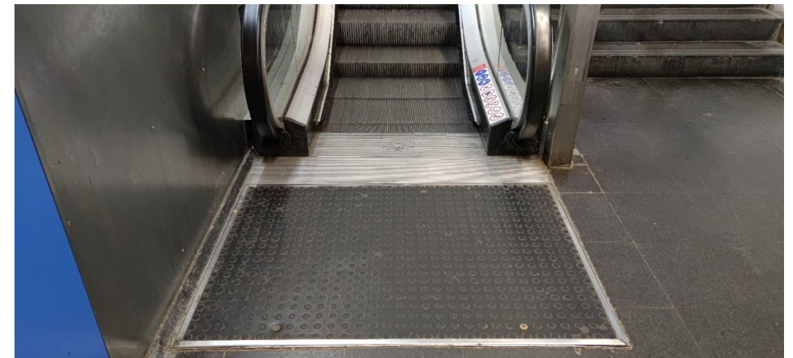
Imatge 75. Fossat de l'embarcament inferior de les escales E3 de l'estació Ciutadella de línia 4
