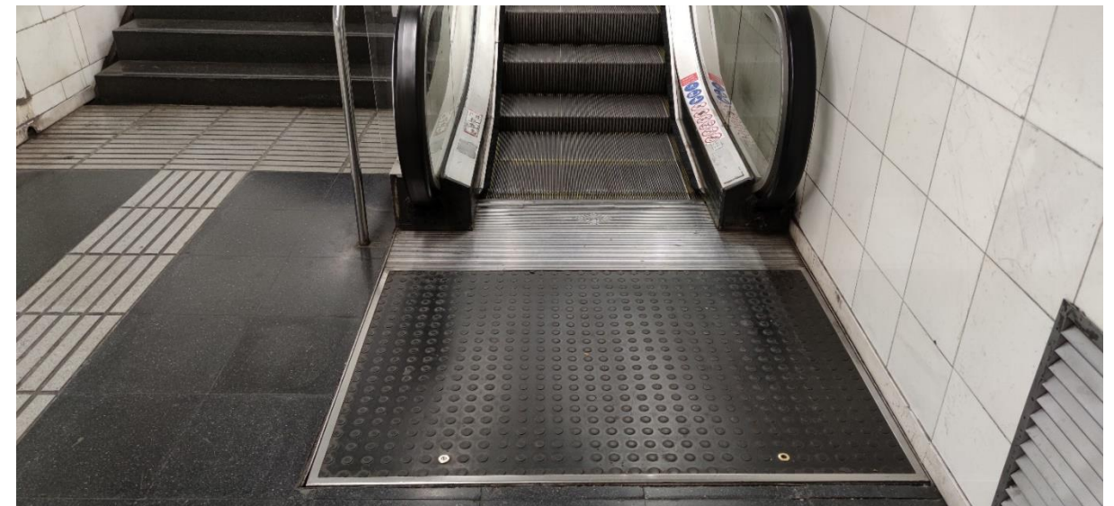
Imatge 27. Fossat de l'embarcament inferior de les escales E3 de l'estació Fondo de línia 1
