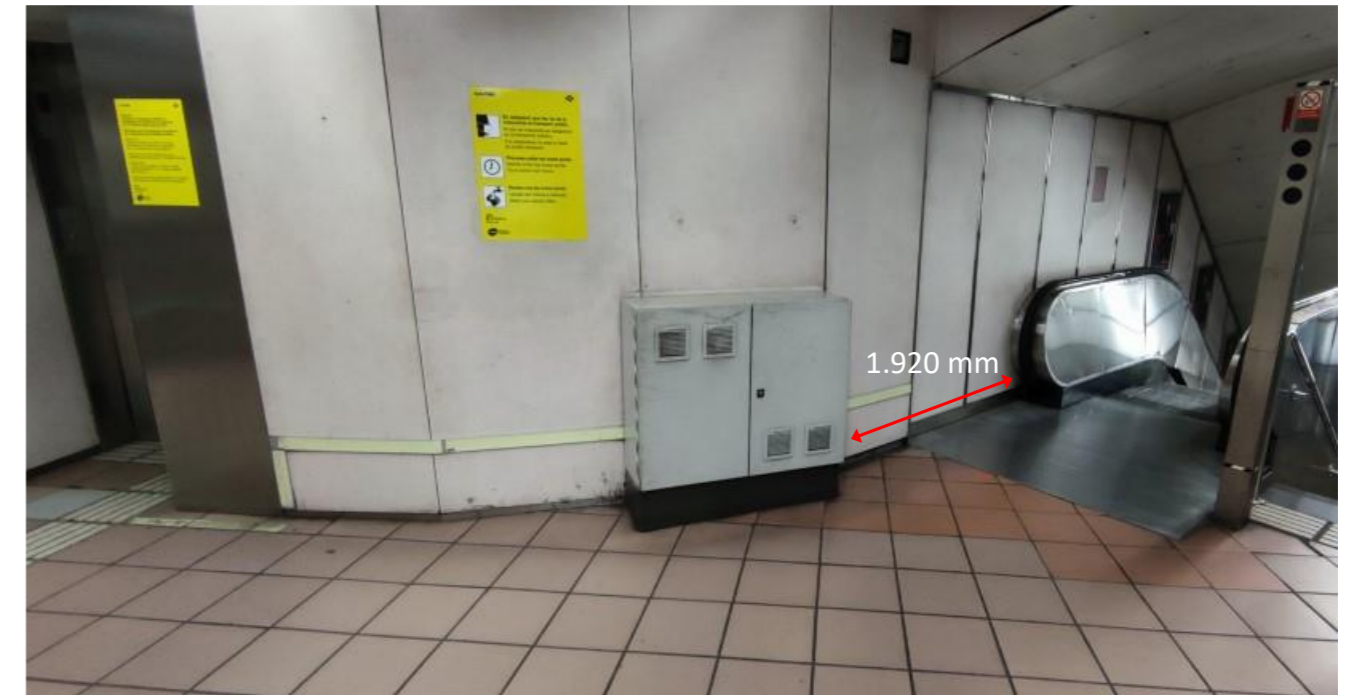
Il·lustració 43. Ubicació del quadre existent i distància fins la part superior de la barana de les escales E1 de l'estació Fontana de línia 3.
