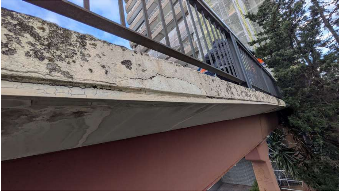
Imatges generals de les fissures al taulell de formigó
