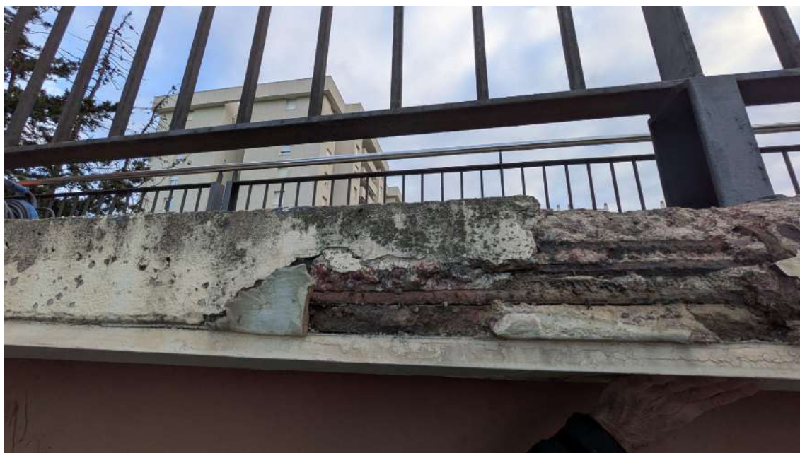
Imatge d'una part que es va desprendre durant la inspecció, en tocar-la
