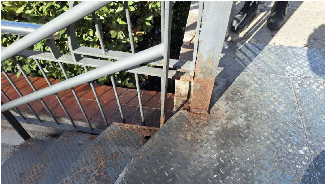
Imatge de l'estat dels perfils i xapes de l'escala de l'accés sud
