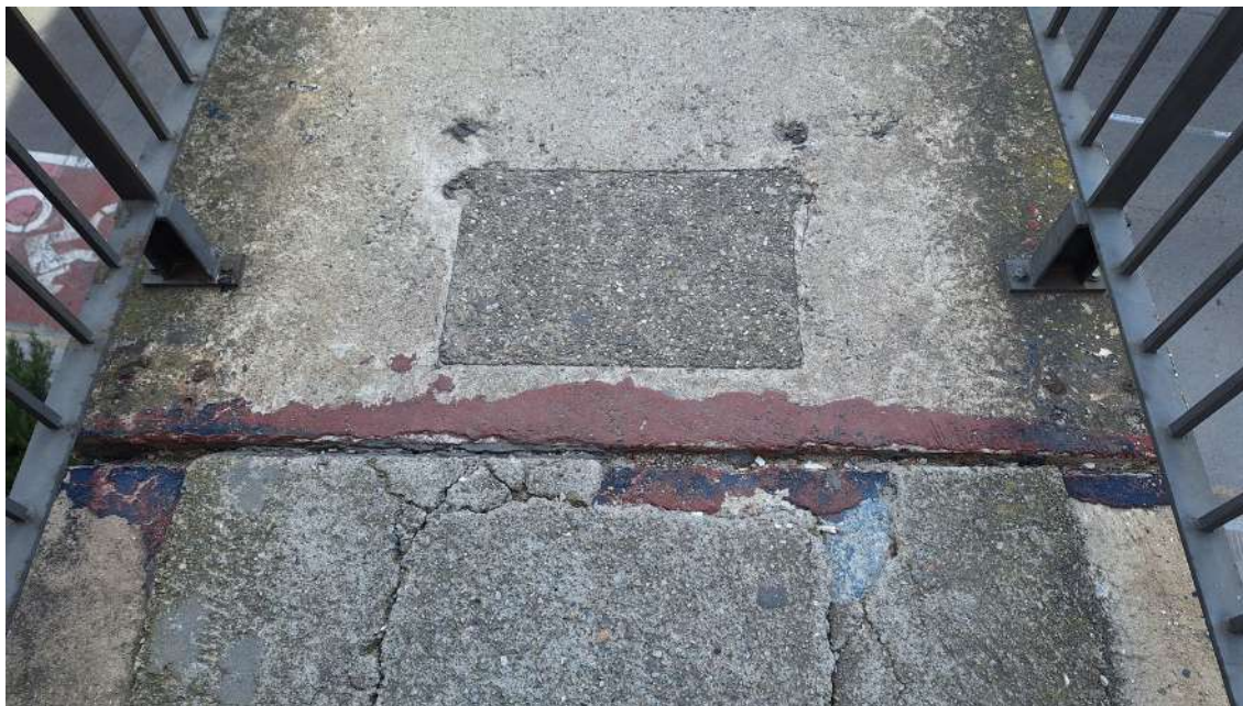
Imatge de l'estat del paviment de la passera
