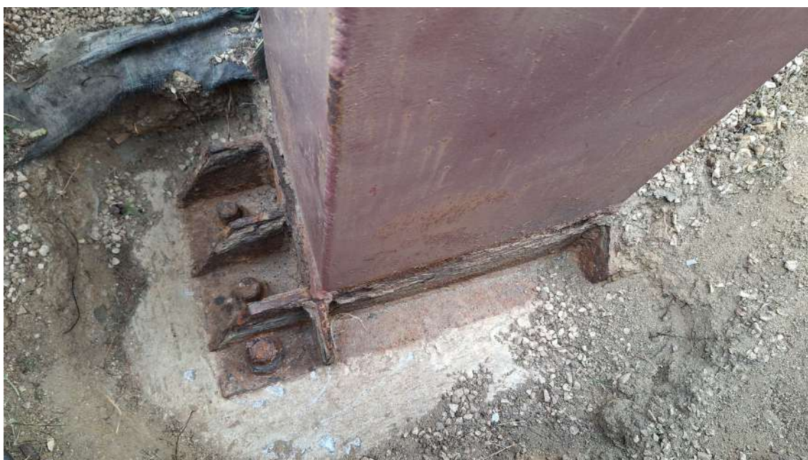
Imatge de l'estat d'oxidació de la placa d'ancoratge del pilar central
