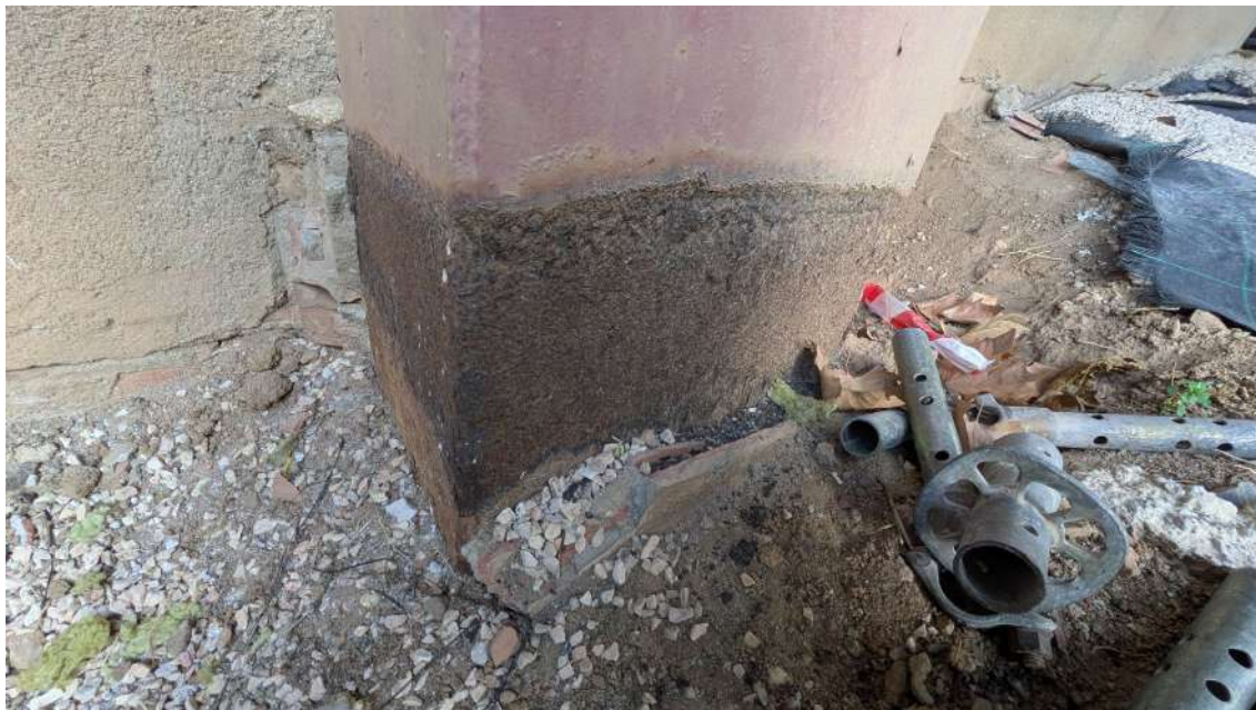
Imatge de l'estat d'oxidació de la zona inferior del pilar nord
