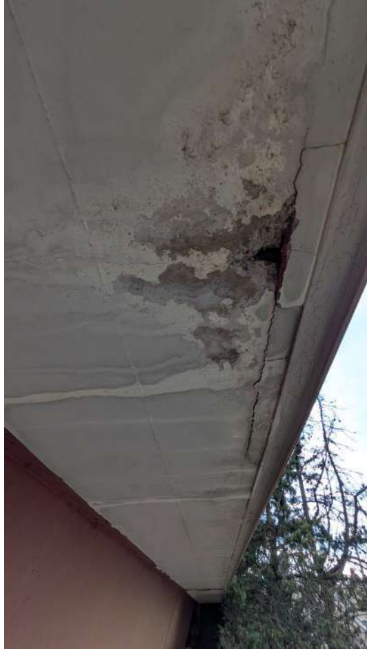
Imatge de trams amb perill de desprendiments al taulell de formigó
