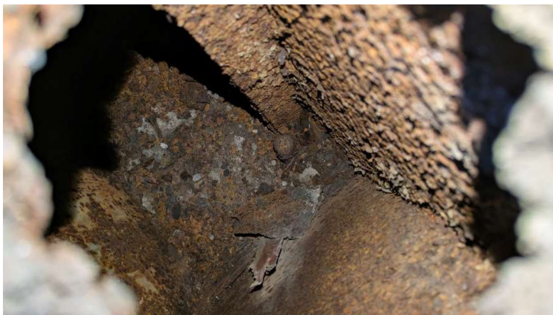
Imatge de l'estat interior de les xapes de la biga
