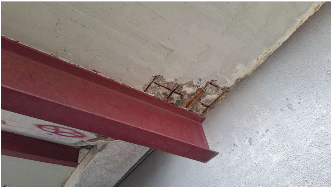
Imatges de l'estat de la llosa de l'escala de l'accés nord
