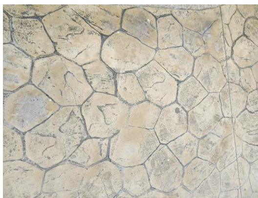
Lot 2: Salomó, paviment existent formigó imprès a fer semblant.
