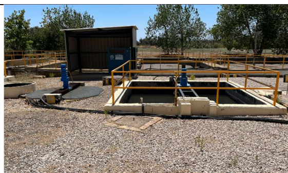
Arqueta floculació i repartiment
