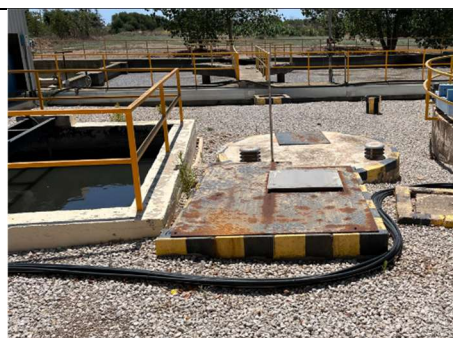
Arqueta floculació i repartiment
