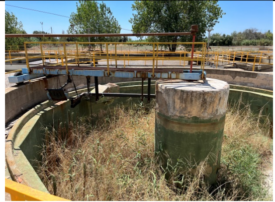
Foto Núm. 12 Decantador primari línia antiga
