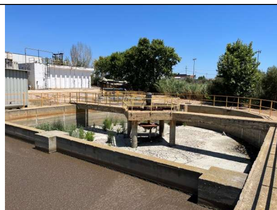
Vista reactor biològic a reparar
