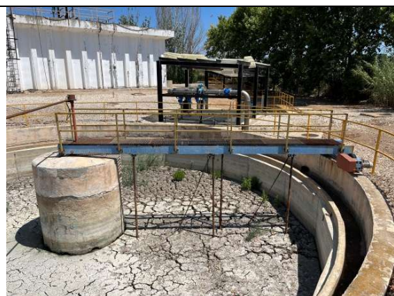
Vista decantador secundari línia antiga a reparar
