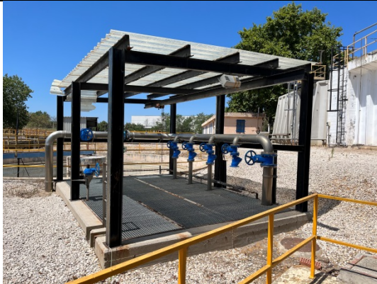
Foto Núm. 25 Estació bombament aigua tractada
