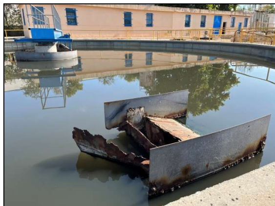
Vista de la cistella de recollida de flotants del decantador primari a substituir
