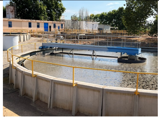
Foto Núm. 14 Decantador secundari línia nova
