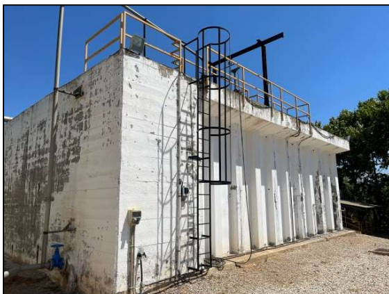
Vista exterior del tanc d'homogenització n°1
