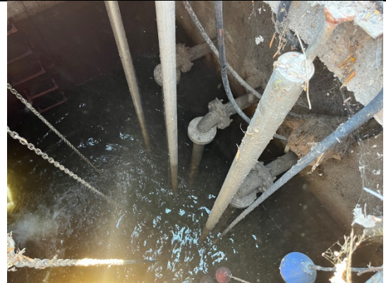
Foto Núm. 26 Estació bombament NIRSA
