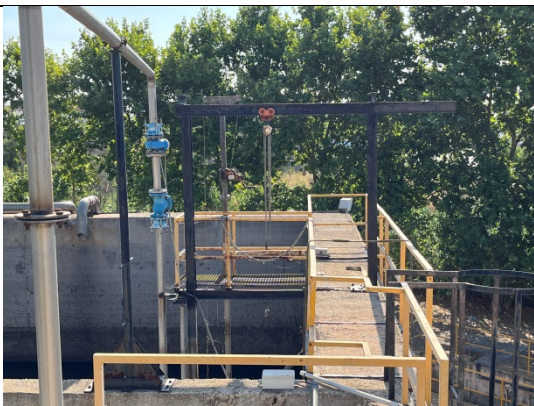
Foto Núm. 5 Detall plataforma d'accés a bomba i agitador del tanc d'homogenització n°1
