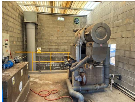
Centrífuga PIERALISI FP600/M existent a reubicar en el nou cobert metàl·lic diàfan a construir
