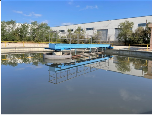
Foto Núm. 11 Decantador primari línia nova
