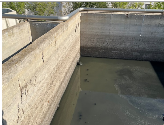
Foto Núm. 6 Vista interior del tanc d'homogenització n°1
