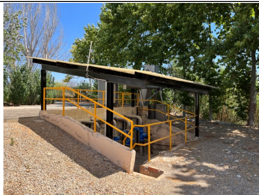
Foto Núm. 3 Estació elevació als tanques d'homogenització
