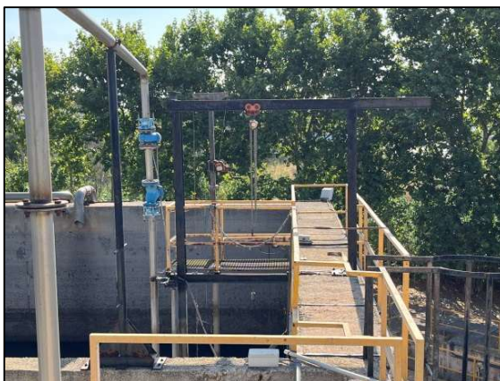
Detall plataforma accés a l'agitador submergit del tanc d'homogenització nº1
