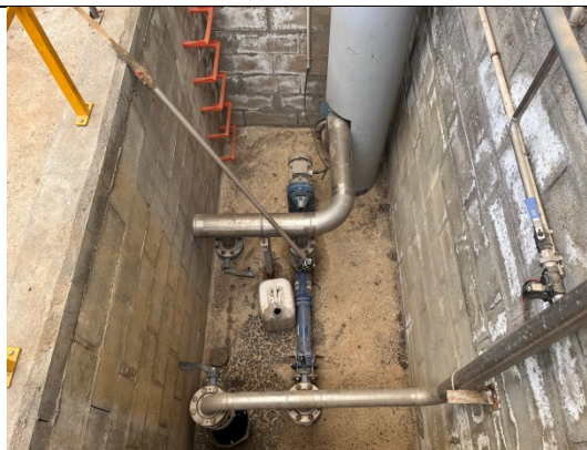
Foto Núm. 18 Bombes de fangs d'espesidor a centrífuga
