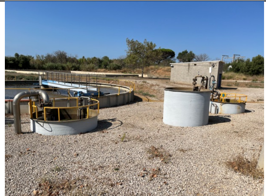
Foto Núm. 16 Arquetes de recirculació, purga i drenatges
