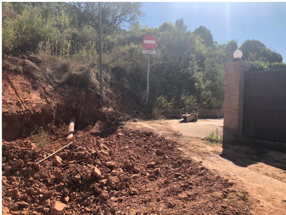
Fotografia 12. Canonada baixada de dipòsit fibrociment descoberta per averia
