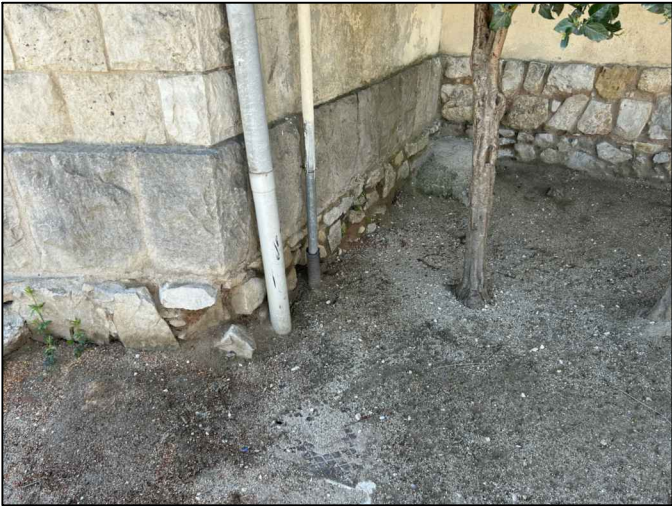
FOTOGRAFIA FAÇANA ESCOLA A INSTAL·LAR COMPTADOR
