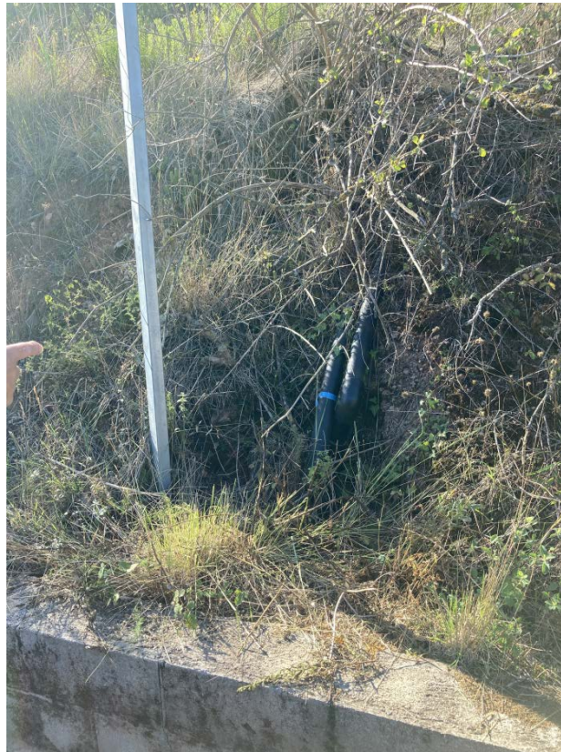
Fotografia 11. Canonada pujada a dipòsit
