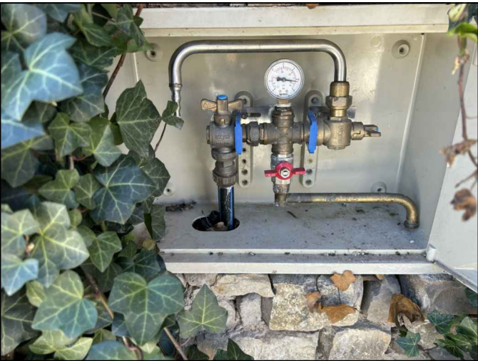
FOTOGRAFIA 2 ARQUETA PRESA DE MOSTRA
