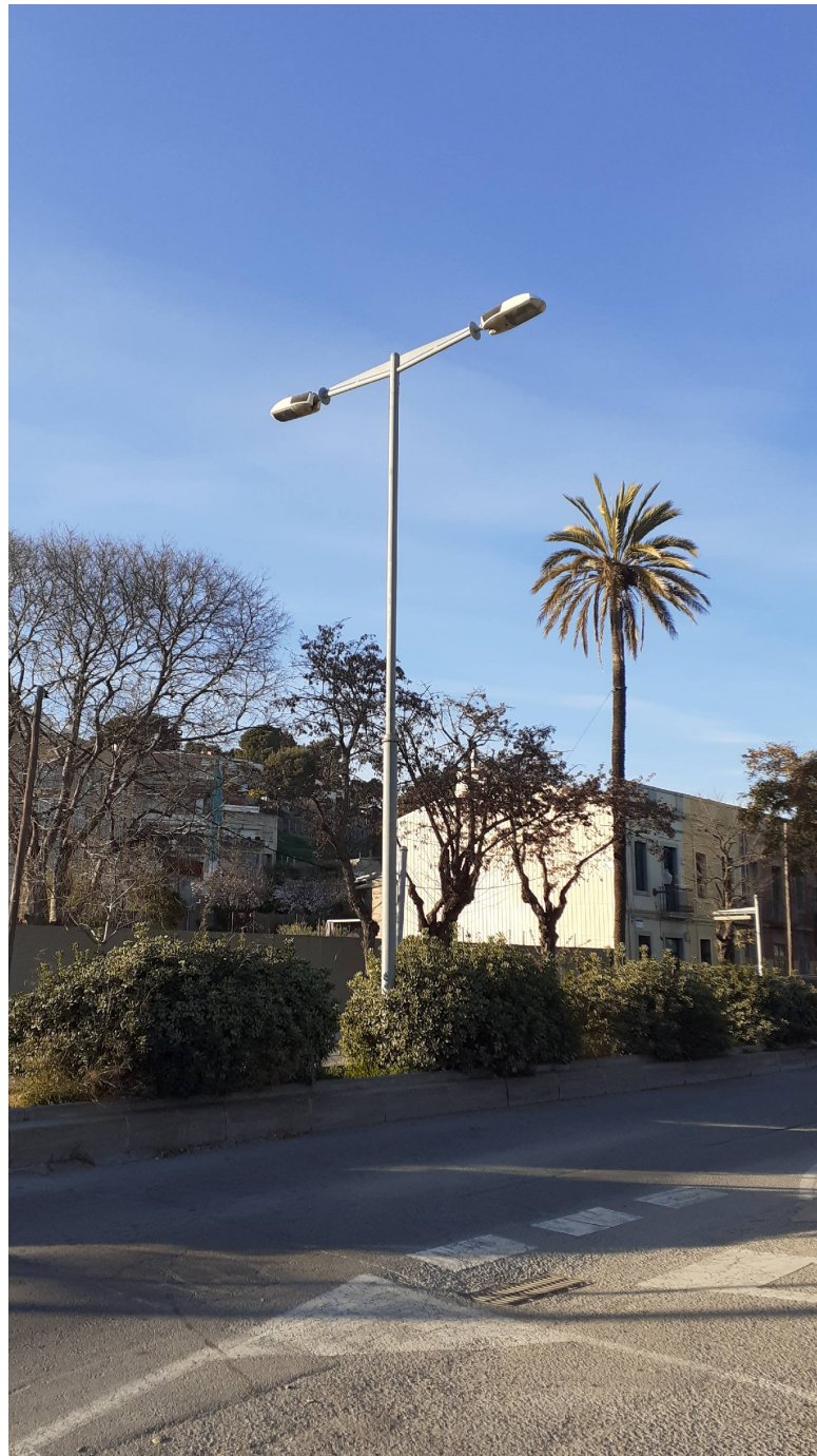
Enllumenat en columnes de 10 m d'alçada situades a la mitjana del carrer Bonaventura Calopa, amb doble llumenera de v.s.a.p. de 150 w, tipus QSA de CARANDINI, a substituir per l'Ajuntament
