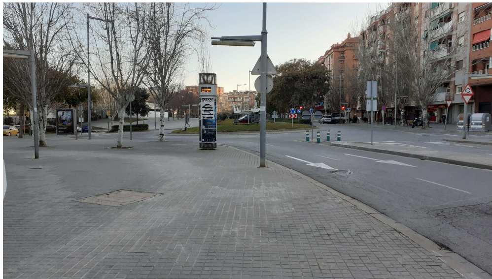
Enllumenat existent a la vorera al carrer Mossèn Pere Tarrés, al costat del quadre nº 113.
