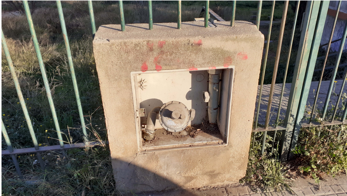
Antiga escomesa de gas, al límit de la vorera amb el solar al costat de l'hospital.
