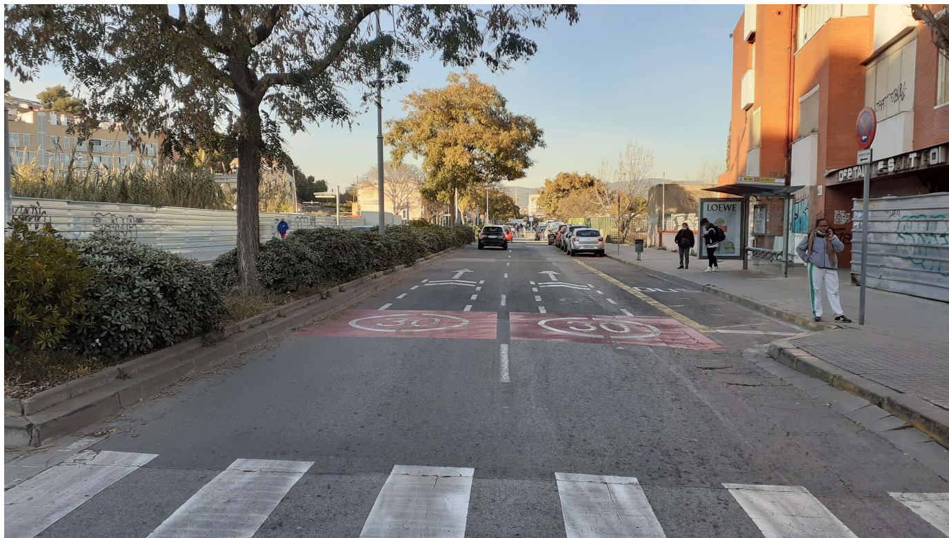
Mitjana, calçada de dos carrils + parada de BUS, vorera del carrer Bonaventura Calopa, amb la parada de BUS davant de l'antic hospital, i un paviment de calçada de mescal bituminosa en calent, que presenta diferents desperfectes, esquerdes, "pell de cocodril" pel seu desgast
