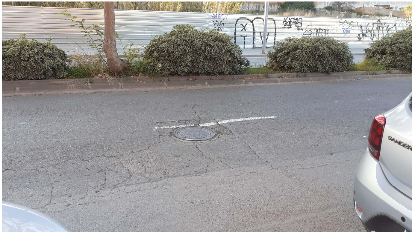
Calçada amb esquerdes sobre el paviment de mescal bituminosa en calent i tapa de registre d'un col·lector municipal de clavegueram, al inici del carrer Bonaventura Calopa.
