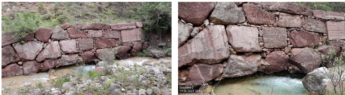
Figura 35. Diferents exemples de punts on el mur d'escullera s'ha soscavat i necessita recalçat.
