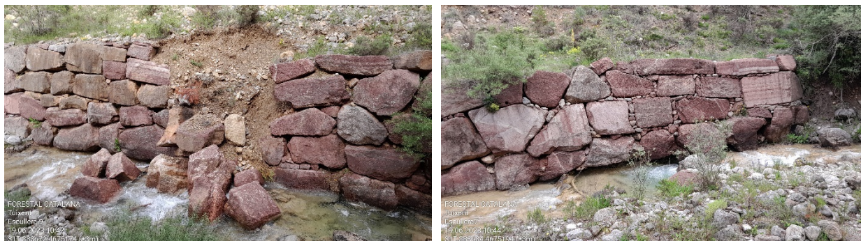
Figura 12. Estat actual de l'escullera. La imatge de l'esquerra ensenya un tram on l'escullera s'ha desmuntat parcialment, restant les roques a la llera. La imatge de la dreta ensenya un tram on s'ha produït socavament i l'escullera resta totalment descalçada.
