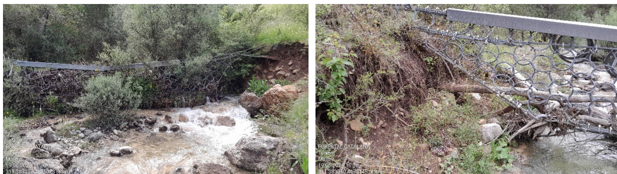
Figura 32. Exemple de l'estat d'un dels dics de contenció afectats. La imatge de l'esquerra mostra com el dic resta totalment colmatat, creant una desconexió en el curs fluvial i provocant el desviament del flux d'aigua cap al marge, generant la seva erosió. La imatge de la dreta ensenya en detall l'ancoratge d'un dels dics al marge erosionat, que fa necessària la seva consolidació per evitar el col·lapse del mateix.
