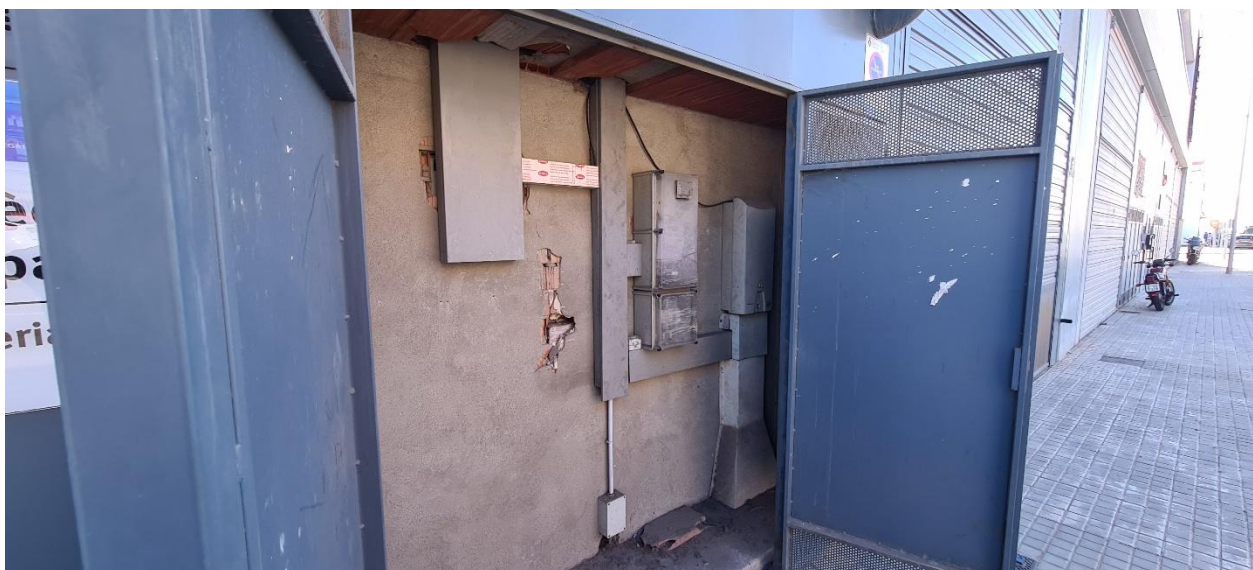
Fig. 15 Vista ubicació armari nova TMF10 FV amb TMF client i CDM (Carrer Tints 9)
