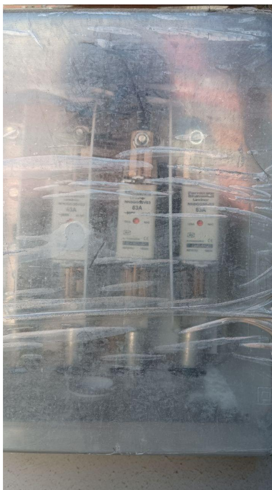
Fig. 19 Detall fusibles TMF1 client C/Tints 9
