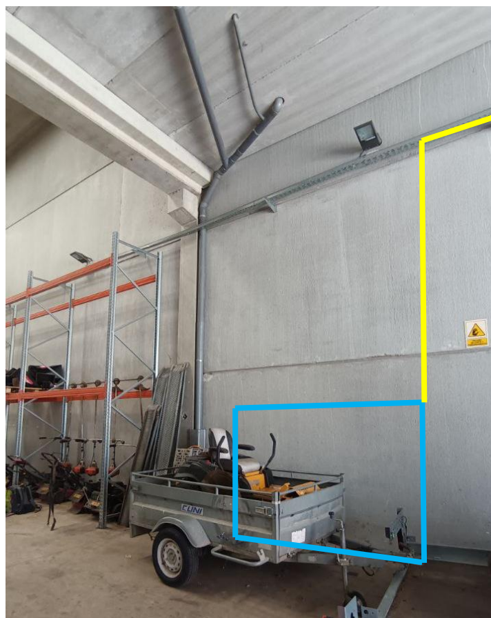
Fig. 14 Vista ubicació inversor, proteccions i bateries
