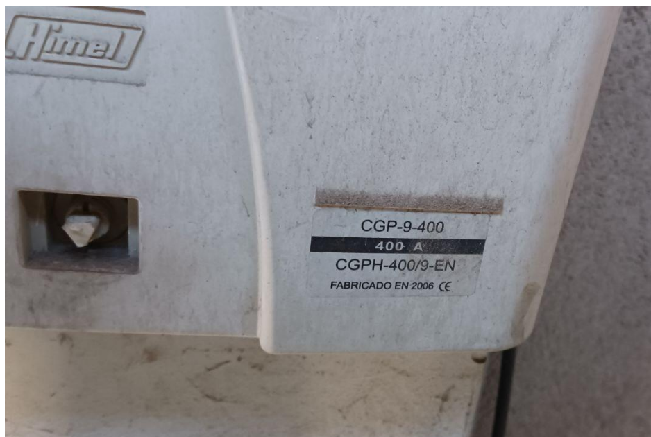
Fig. 17 Detall CGP existent C/Tints 9
