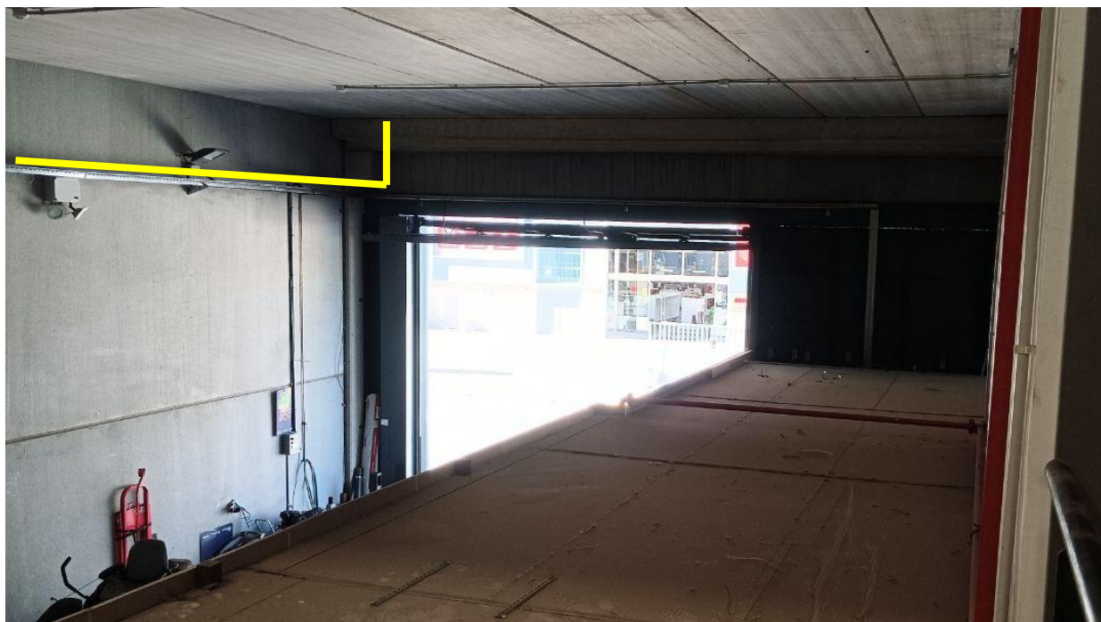
Fig. 13 Vista pas de cablejat des de façana a interior nau per safata existent
