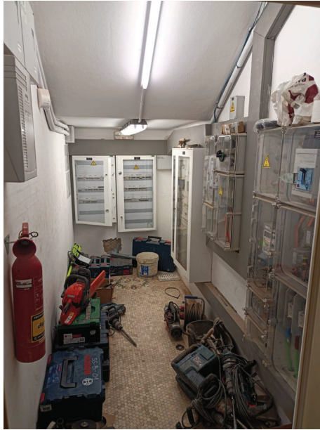
Imatge 5. Sala de comptadors i quadres
