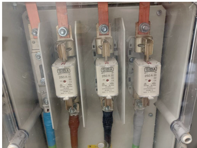
Imatge 22. Fusibles en la TMF-10 de consum
