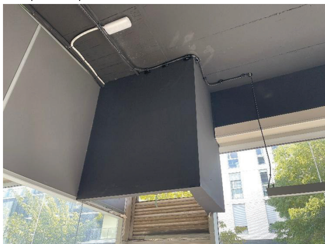
3.Sala: Parament vertical allotjament màquina aire condicionat.
