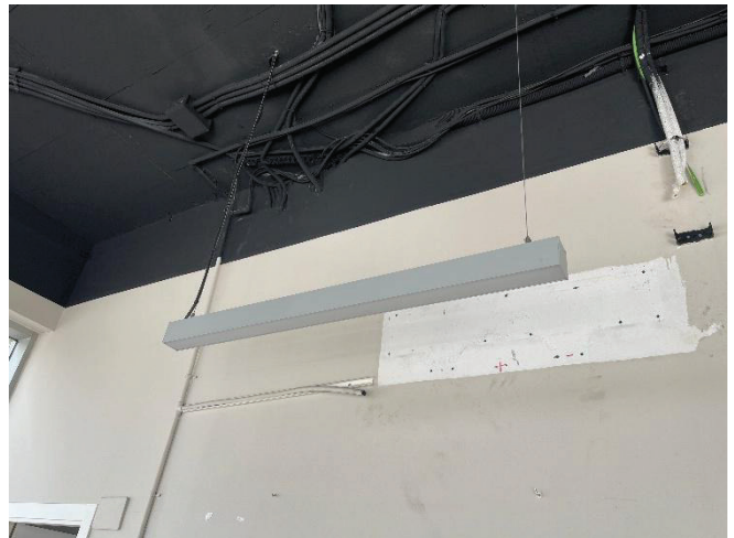
5.Sala: Lluminares en suspensió de 1m.
