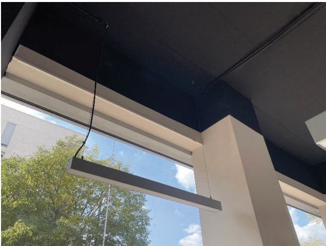
5.Sala: Lluminares en suspensió de 1m.
