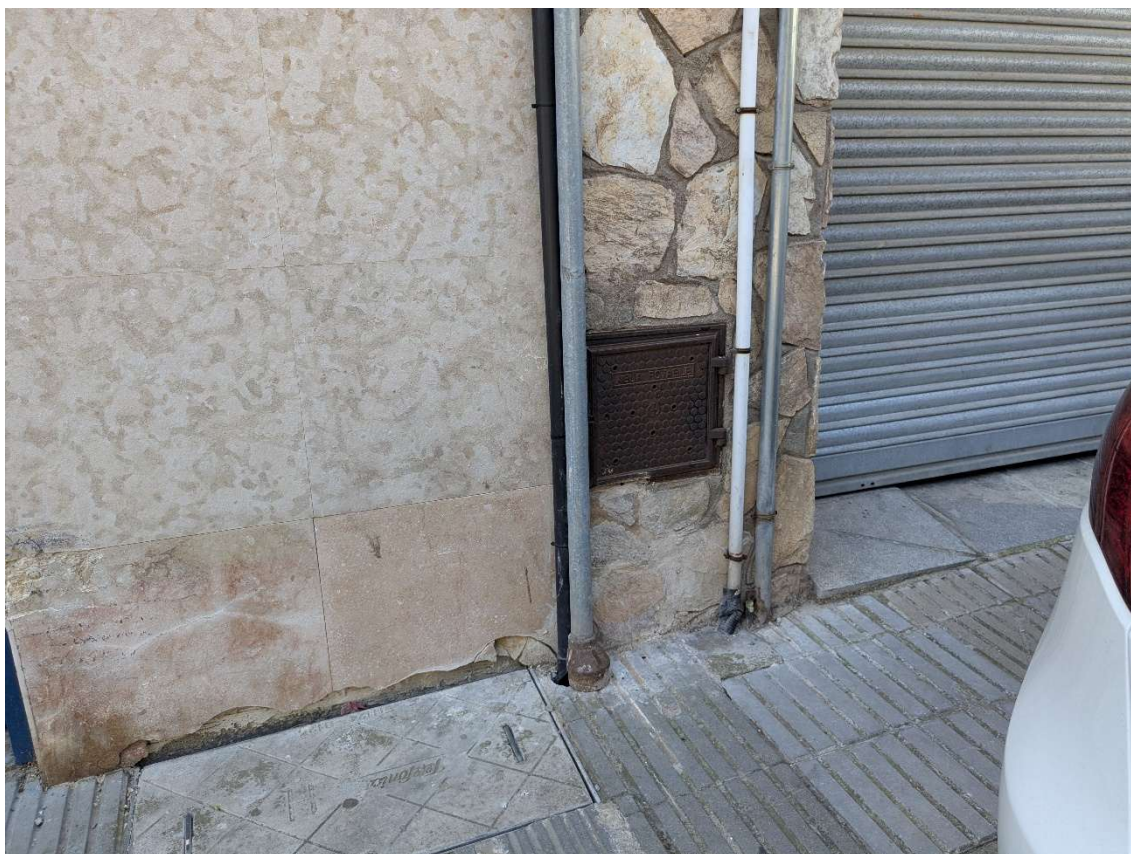
Foto 36: Escomesa d'aigua, i detall xarxa telecomunicacions. Carrer Barcelona.
