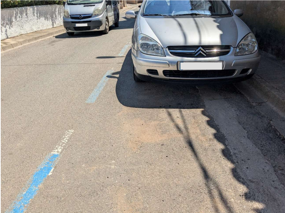
Foto 33: Detall rasa telecomunicacions. Carrer Barcelona.
