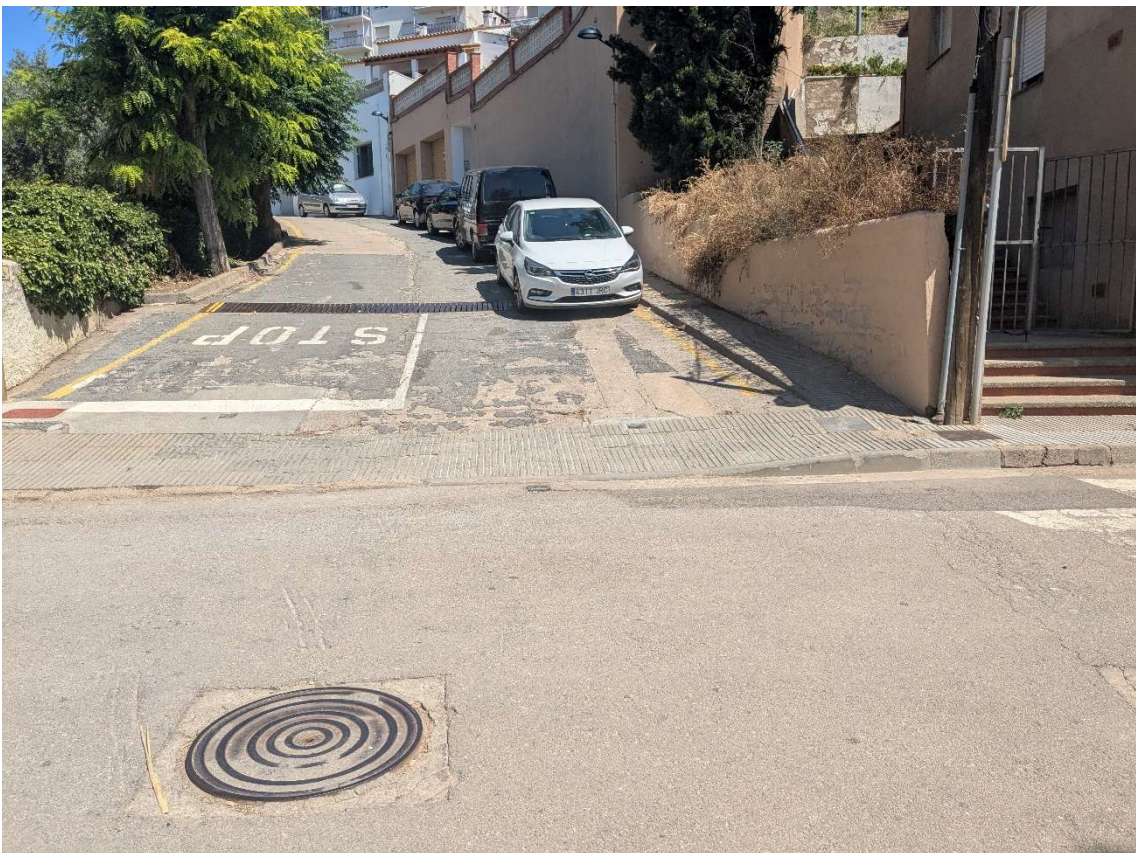
Foto 43: Claus Xarxa d'Aigua. Carrer Barcelona cantonada amb Carrer del Pont Nou.
