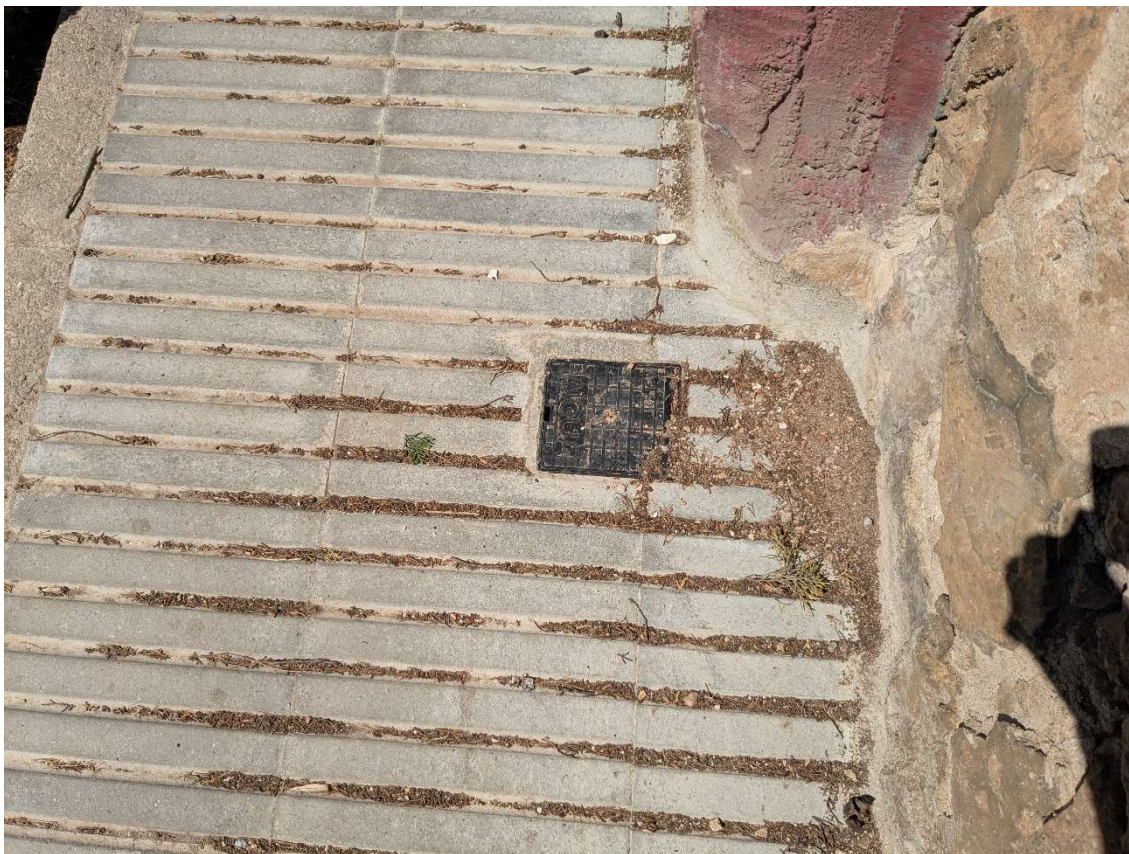
Foto 26: Clau d'escomesa aigua. Carrer Barcelona.
