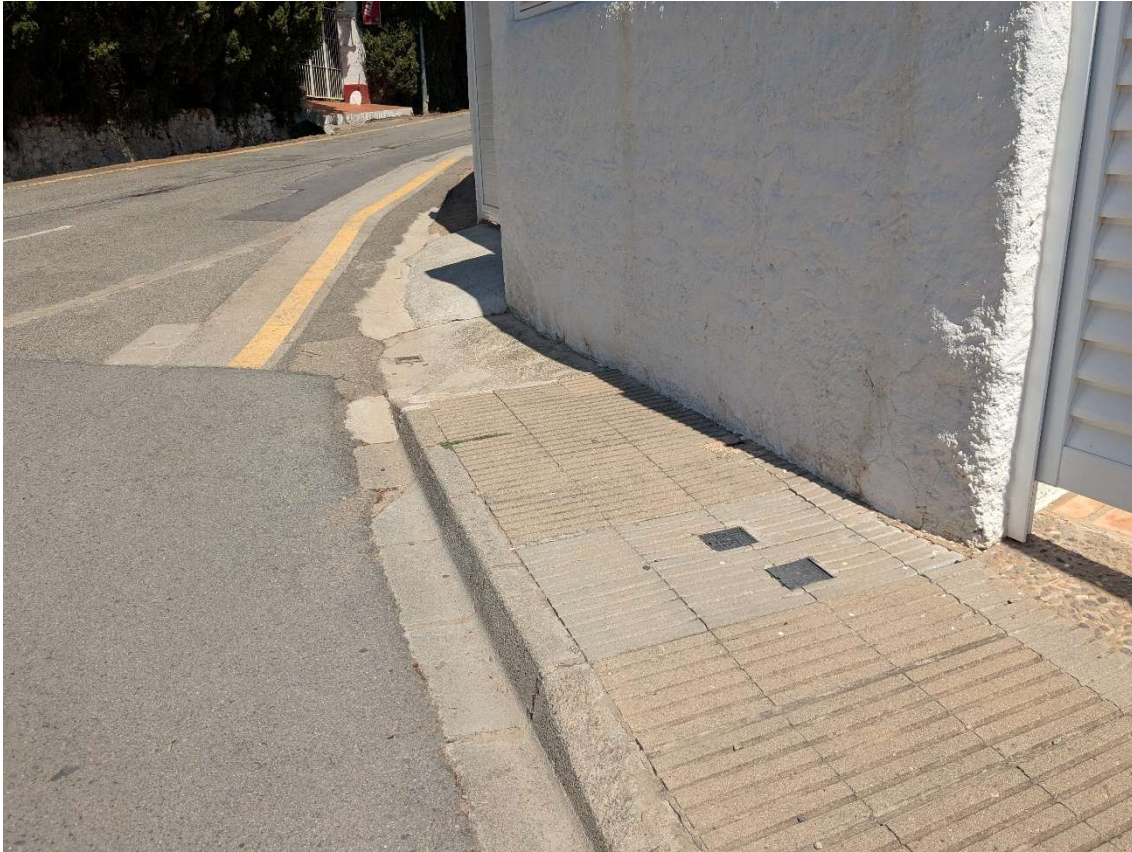
Foto 24: Claus distribució gas. Pujada de la Primavera cantonada amb Carrer Barcelona.
