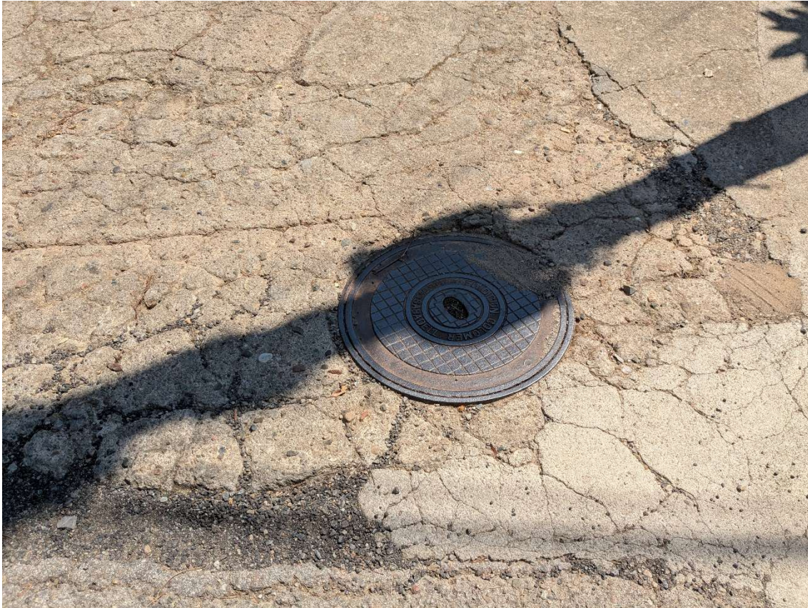
Foto 16: Pou sanejament Carrer del Palangre.
