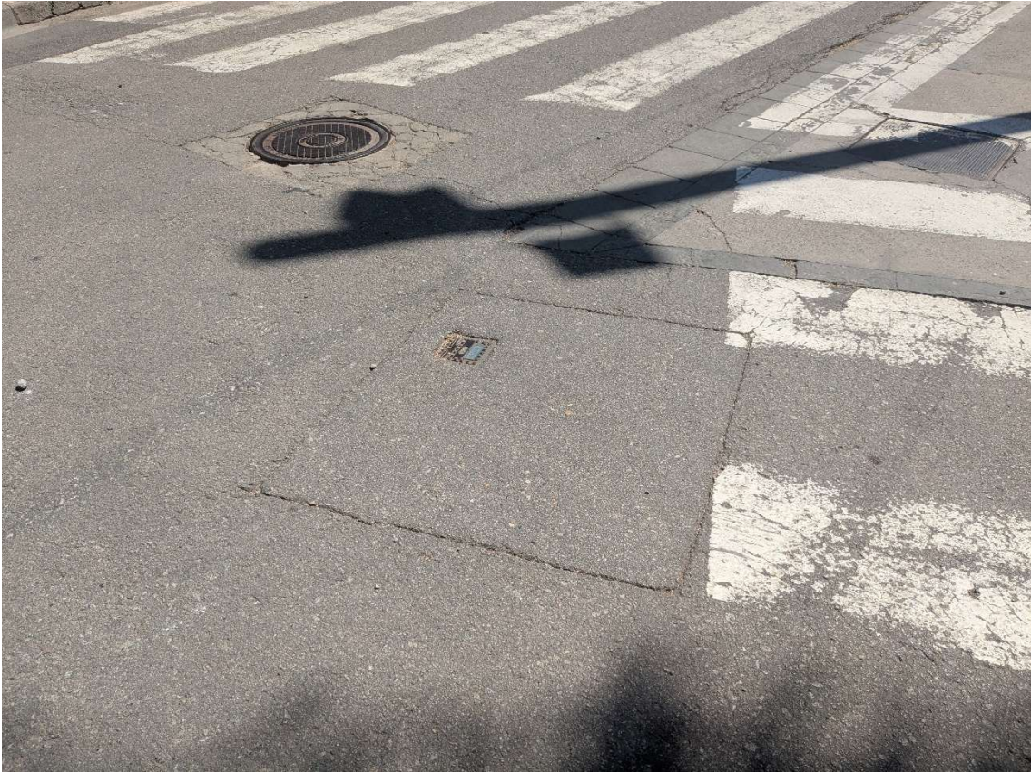
Foto 42: Clau Xarxa d'aigua. Carrer Barcelona cantonada amb Carrer del Pont Nou.
