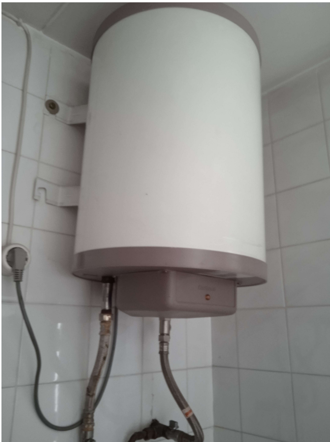
Foto 17: termo acumulador elèctric ACS
