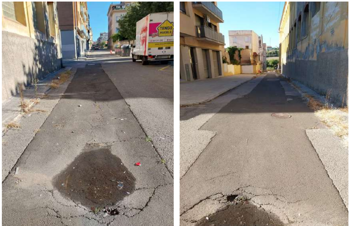
Imatge 6 i 7. Vista del tram executat el 2012 on s'observa molta deformació en l'àmbit de la rasa executada, direcció al carrer de la Caritat i des del carrer de la Caritat.
