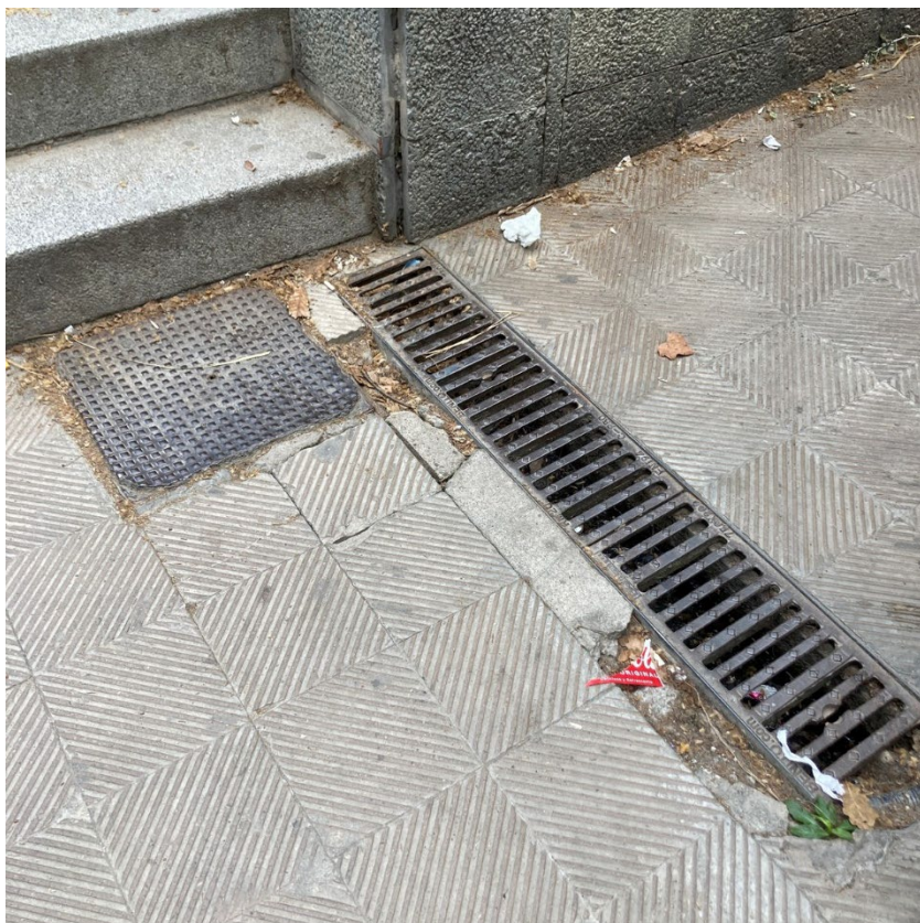
Foto 3. Estat de la reixa de drenatge i del paviment a l'accés del pas.
