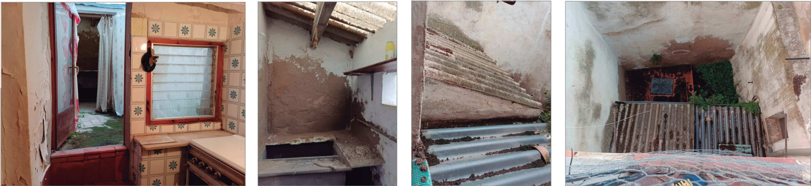
22.23.24. ENDERROC RENTADOR EXTERIOR I EL FORJAT DEL PATI INTERIOR
