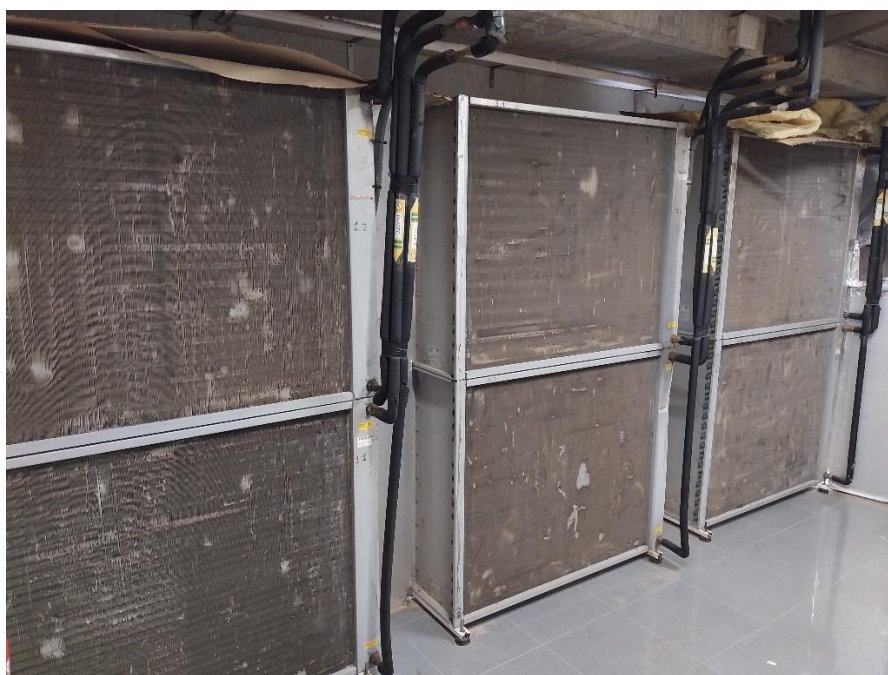
Imatge 2: Unitats exteriors de clima de l'Edifici EDR - ETAP Llobregat
