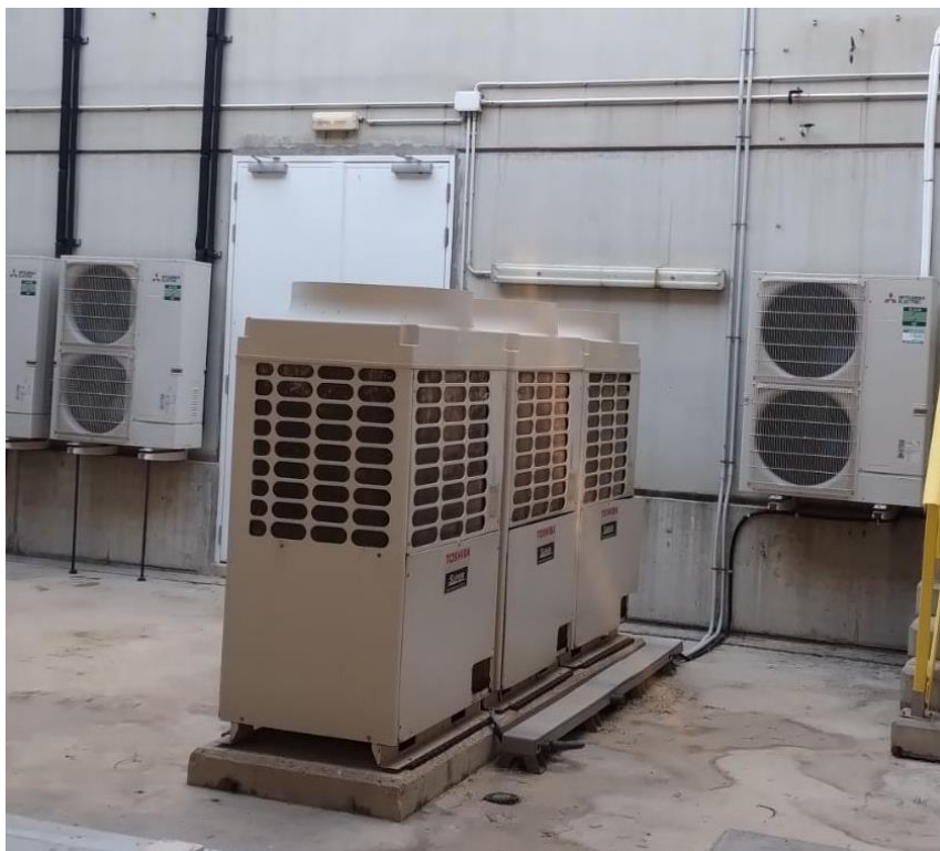
Imatge 6: Unitats exteriors - ITAM Llobregat (Captació)
