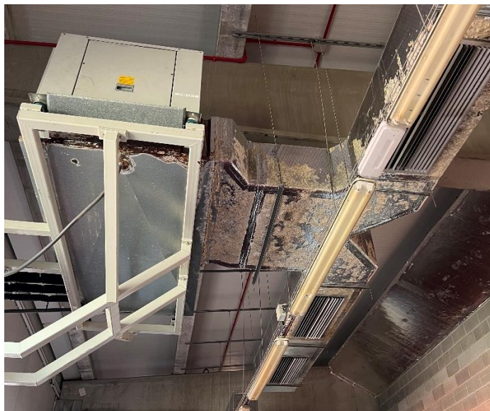
Fig 2: Unitats interiors (ubicades sobre quadres elèctrics) i conductes de ventilació amb un grau elevat de corrosió.
