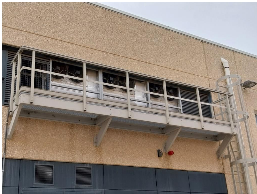
Imatge 1: Unitats exteriors de clima de l'Edifici EDR - ETAP Llobregat
