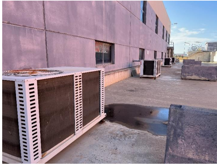
Fig 1: Unitats exteriors (compressors) de climatització amb fuites de refrigerant
