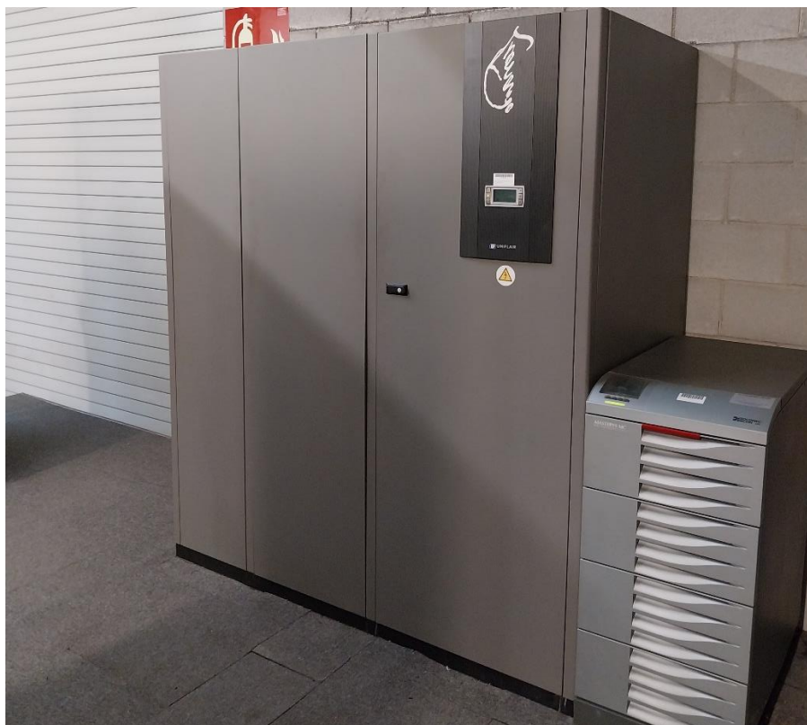
Imatge 3 Unitat interior tipus columna de l'Edifici EDR - ETAP Llobregat
