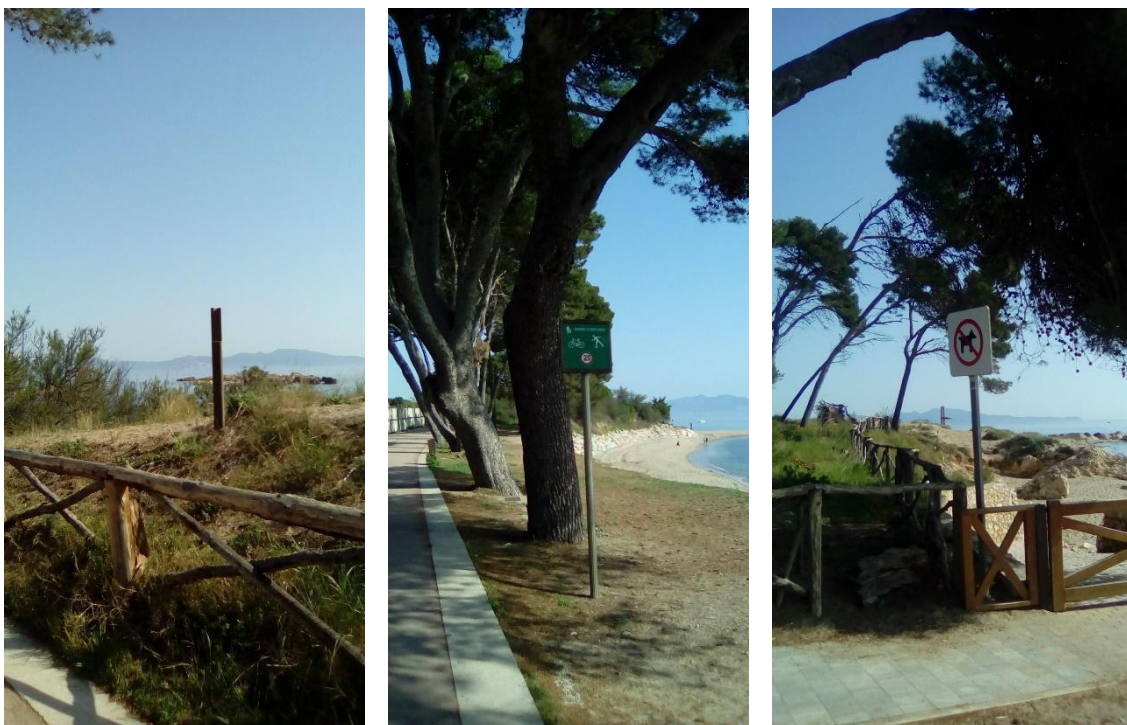
Presència de cartellera en mal estat
