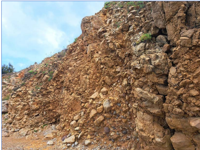
Foto 4. Vista de falques de material rocós inestable en el primer pla i de material de col·luvió englobat dins de matriu llimosa.
