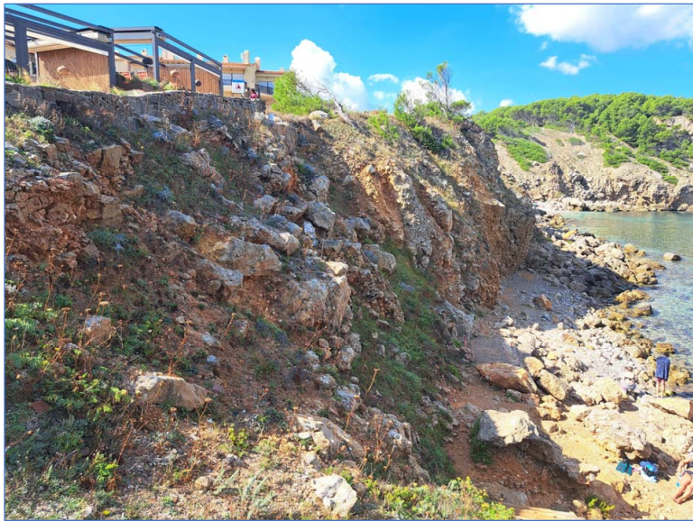
Foto 6. Vista del materials inestables a l'inici del talús i de la gran quantitat de blocs rocosos que s'han després del talús.
