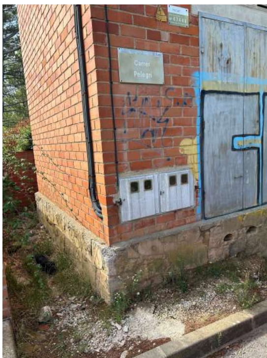
Imatge del CT 47444, i les caixes de l'enllumenat
