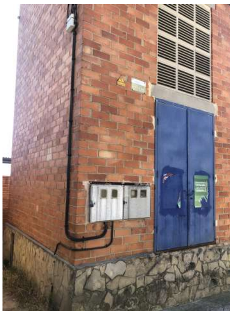
Quadre encastat al CT (EP08 – nucli del Pla de la Torre)
