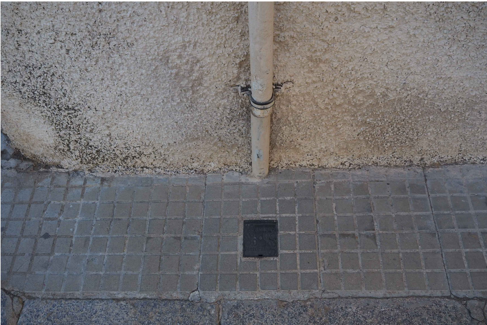
09 Arqueta de gas Passatge Ca la Gràcia - Habitatge nº 6
