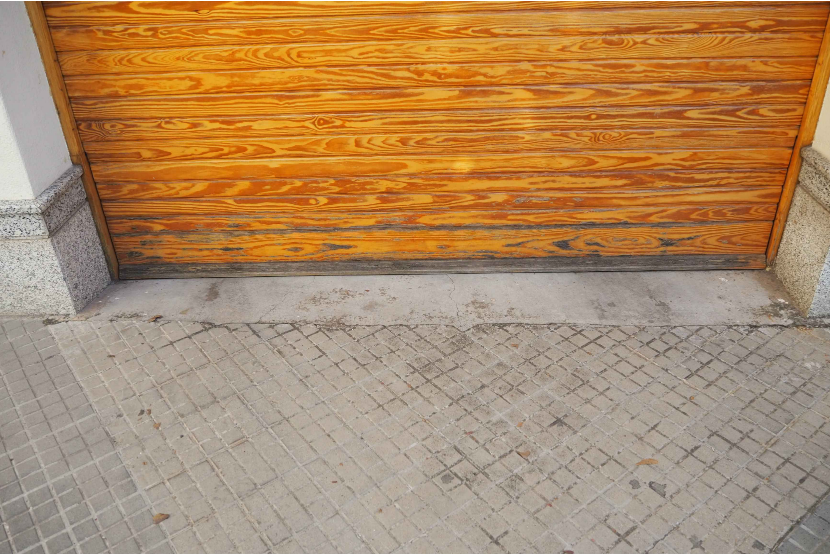
07 Garatge habitatge nº 2 Cota +205,59m - Té pendent cap al interior. Hi ha entrada d'aigua.
