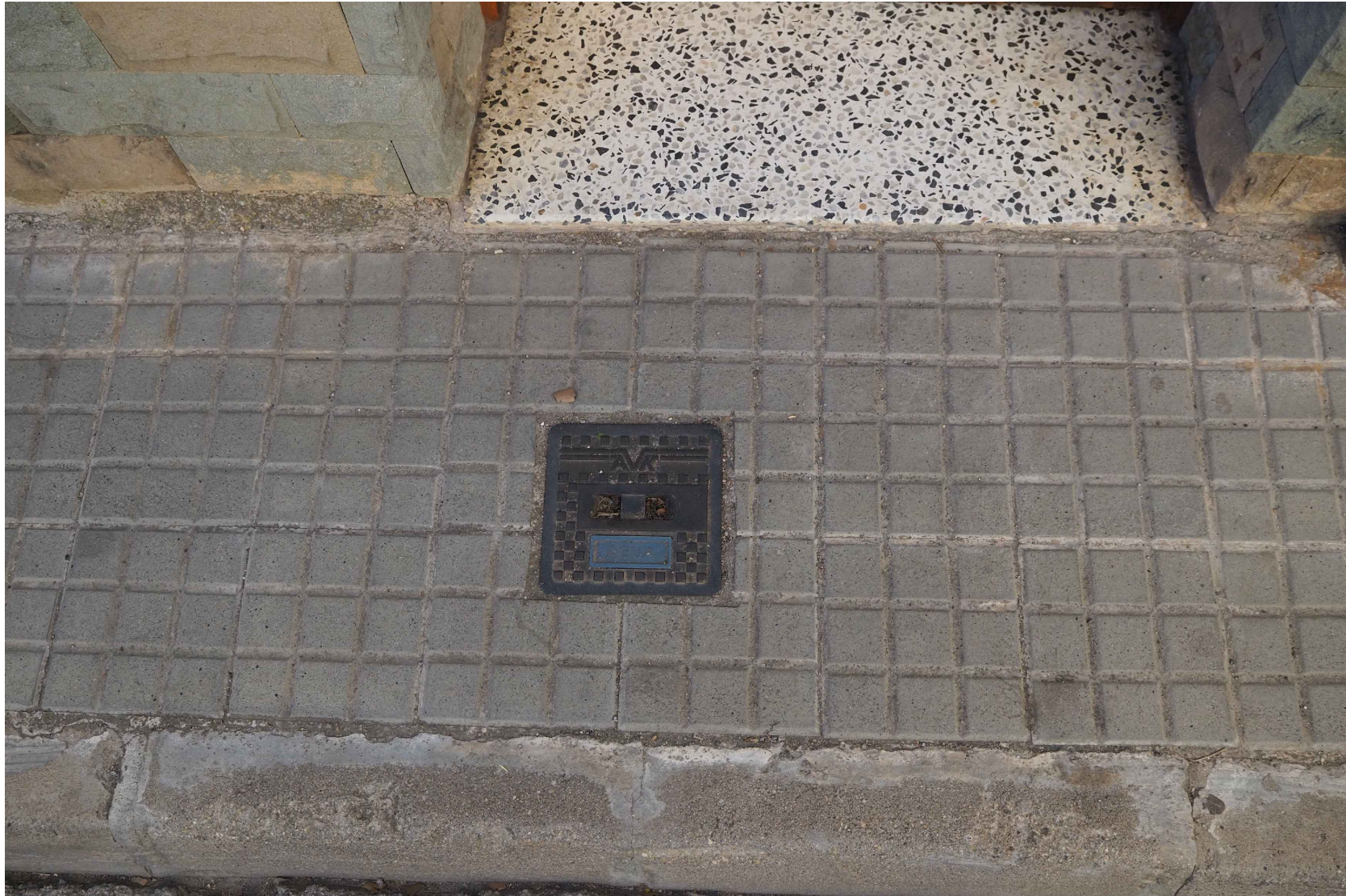
04 Arqueta d'aigua potable Habitatge nº7 - Plaça de Dalt
