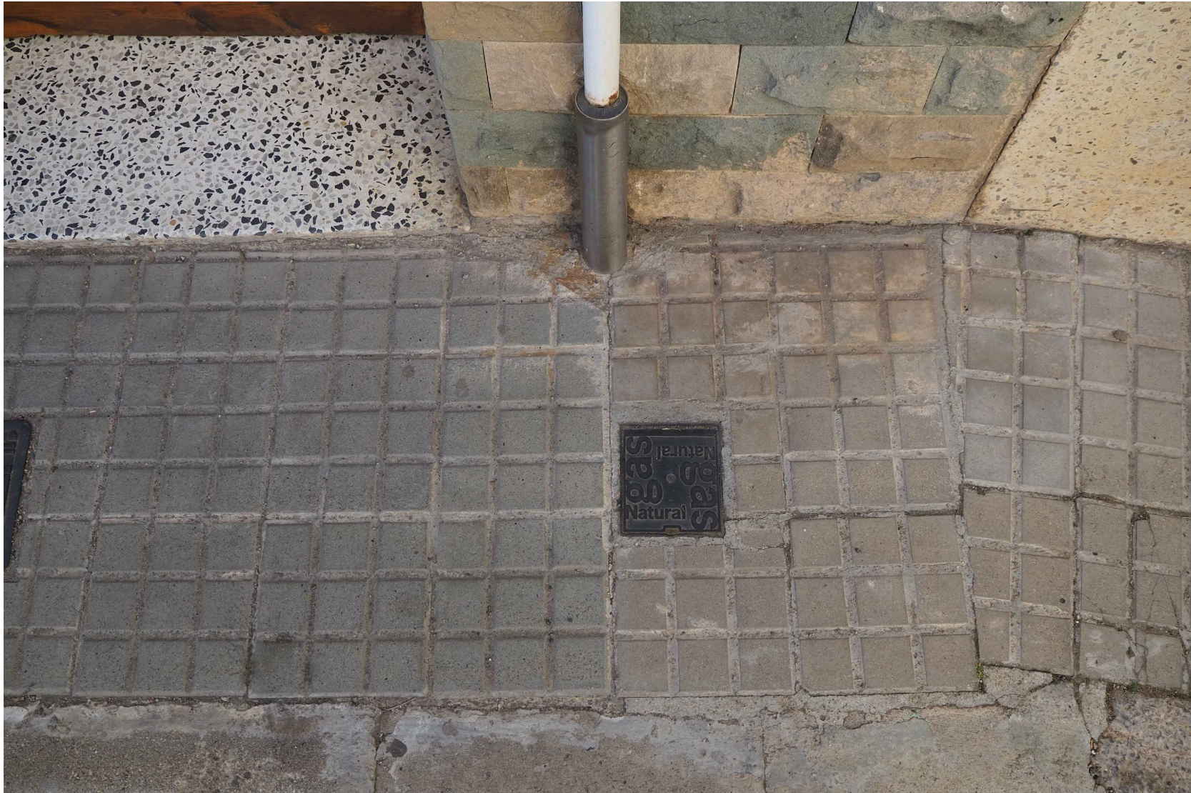
05 Arqueta de gas Habitatge nº7 - Plaça de Dalt
