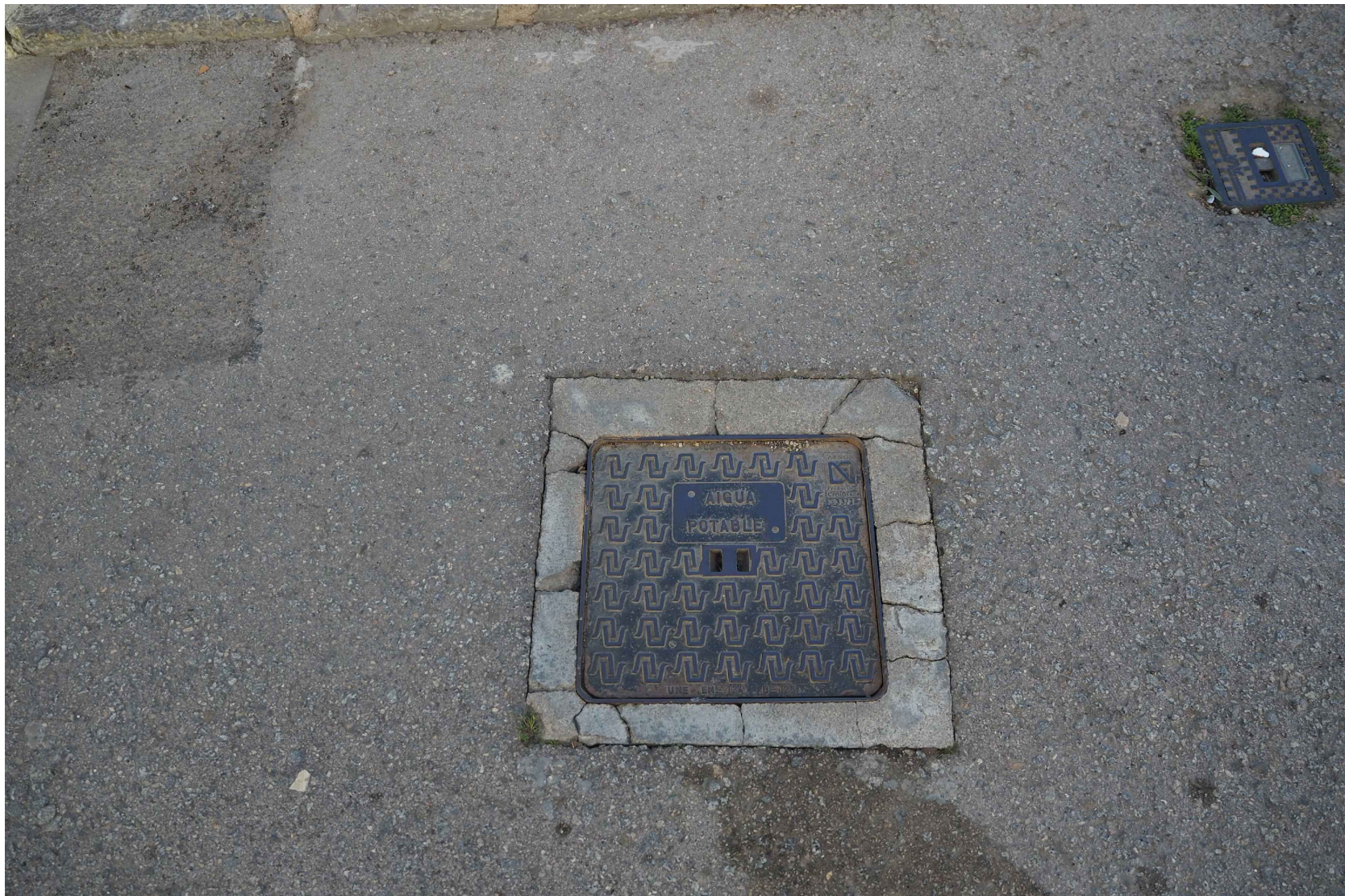
07 Arqueta d'aigua potable Passatge Ca la Gràcia - Zona Mirador
