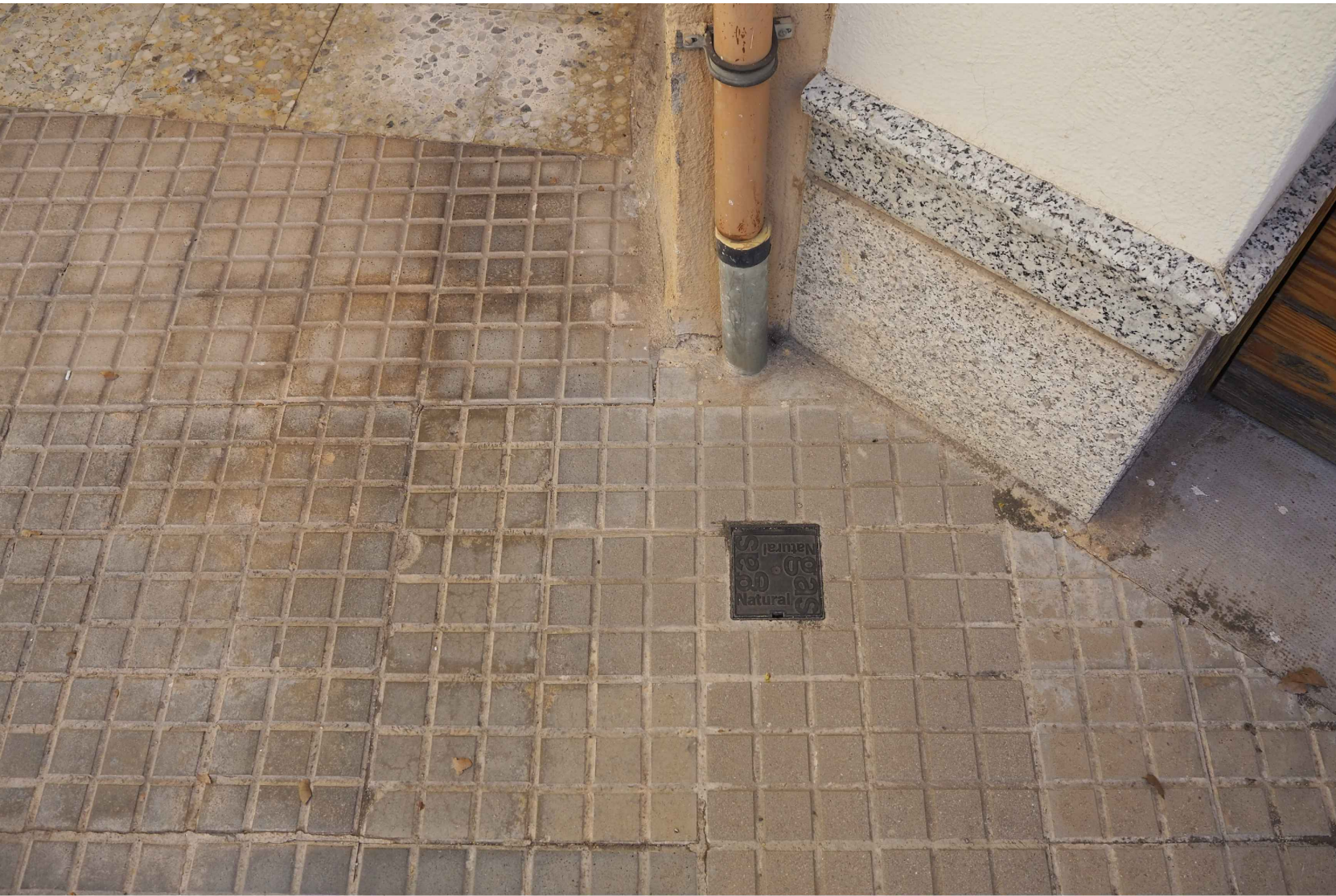
11 Arqueta de gas Passatge Ca la Gràcia - Habitatge nº 6
