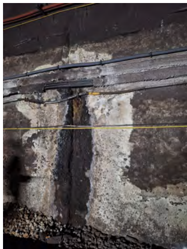
Foto 3: Filtració pantalla PK 106+330 v1.
