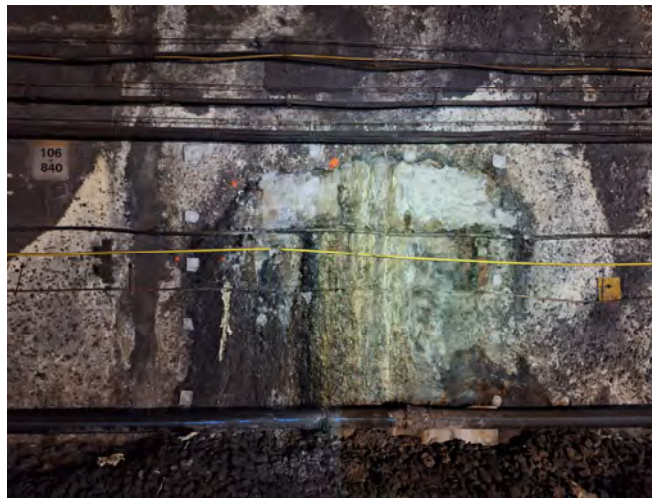
Foto 13: Filtració esquerra pantalla PK 106+840 v1
