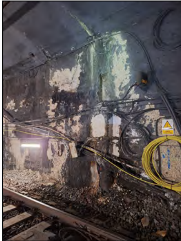
Foto 1: Filtració pantalla PK 106+215 v1.
