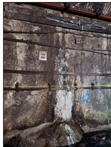
Foto 17: Filtració pantalla PK 106+900 v2.
