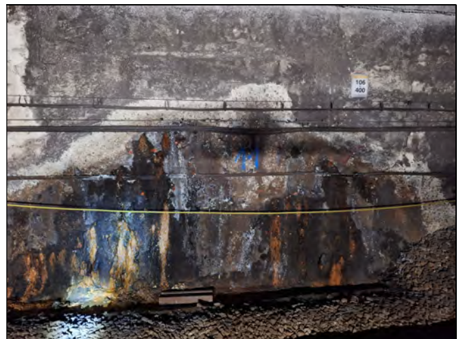
Foto 6: Filtració esquerra pant. PK 106+400-408 v1.
