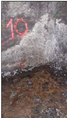
Foto 7: Filtració contravolta PK 105+840 v1.
