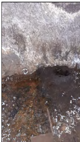
Foto 3: Filtració contravolta PK 105+660 v1.
