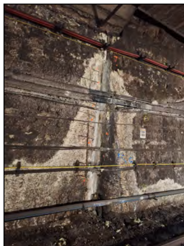
Foto 12: Filtració pantalla PK 106+820 v2.
