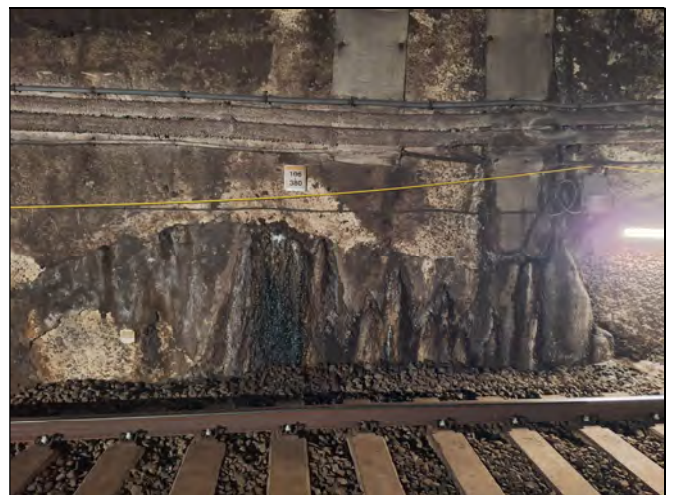
Foto 4: Filtració esquerra pant. PK 106+375-385 v2.
