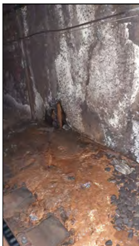
Foto 9: Filtració contravolta PK 105+975 v1.
