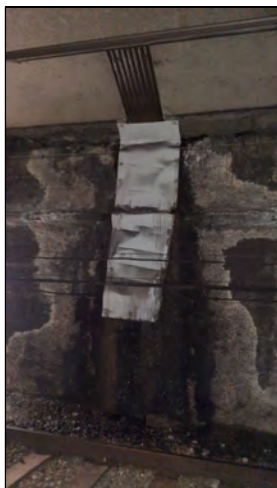
Foto 5: Filtració pantalla-volta PK 105+750 v1.
