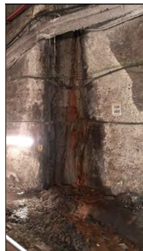
Foto 10: Filtració pantalla PK 106+080 v1.
