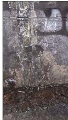
Foto 8: Filtració contravolta PK 105+950 v1.
