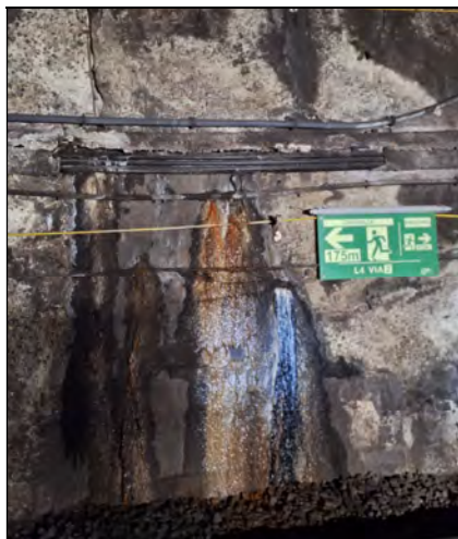
Foto 5: Filtració esquerra PK 106+400 v2.
