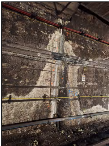
Foto 20: Armadura Vista PK 106+820 v2.
