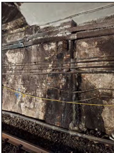
Foto 14: Filtració pantalla PK 106+890 v1
