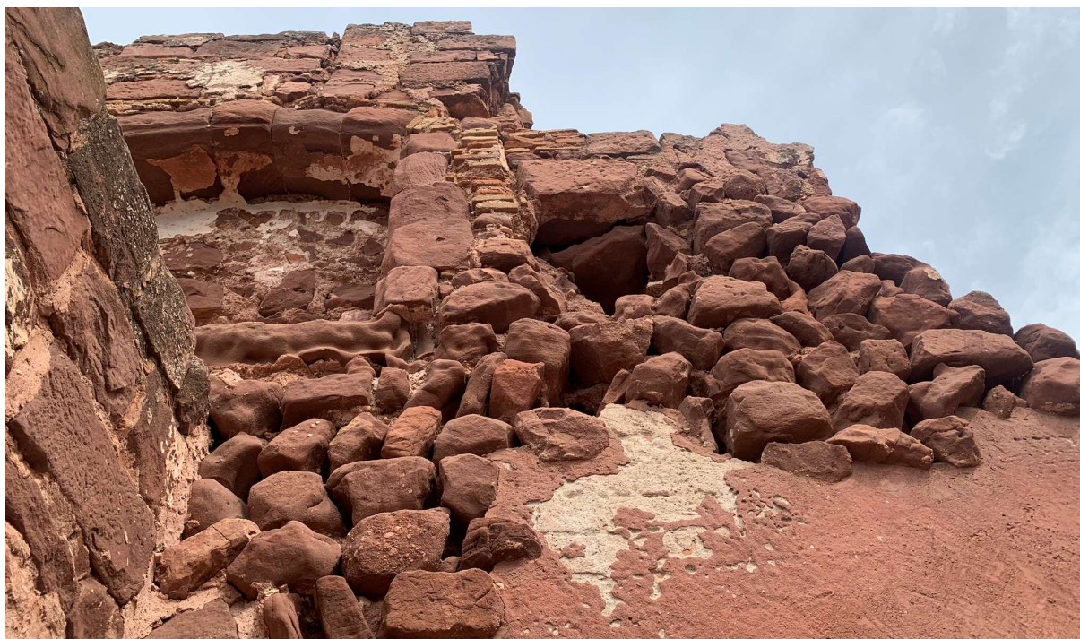
Recinte superior. Disgregació i falta de rejuntat de la maçoneria. Font: Roger Guitart Domingo
