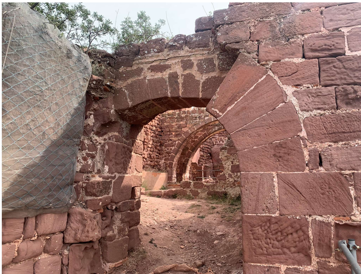
Recinte superior. Mur de migdia del baluard en un estat alarmant de conservació. Font: Roger Guitart Domingo
