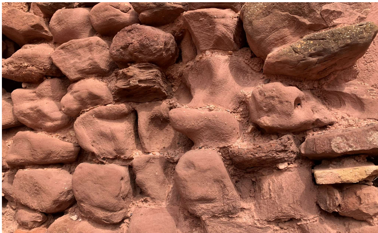
Recinte superior. Disgregació de la pedra. Font: Roger Guitart Domingo
