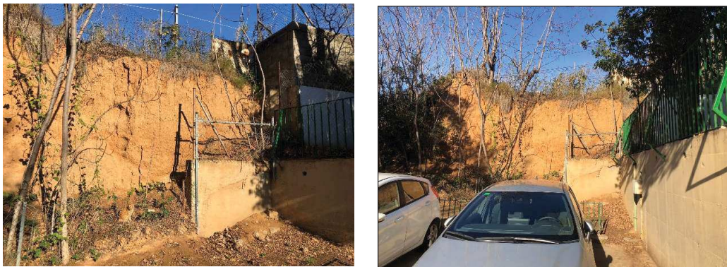
Fotografia 5 i Fotografia 6. Detall del talús subvertical estudiat.
