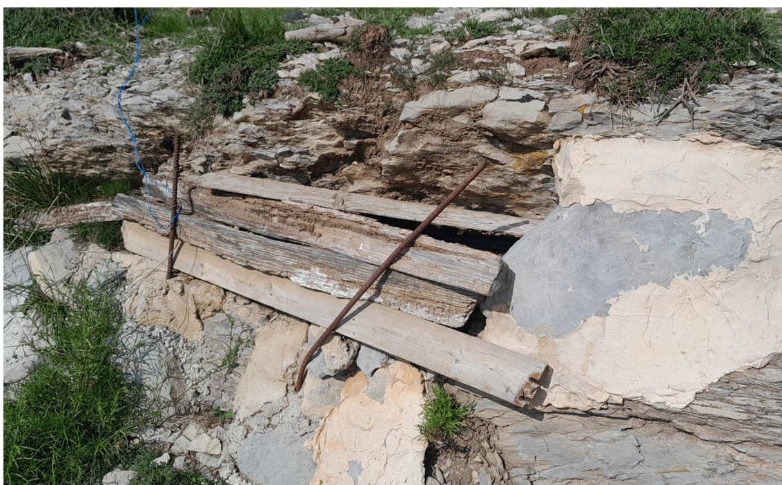
Zona de claus de pas/aixetes actuals a la bassa de can França, a substituir per un armari/marc de formigó amb porta de metall.
