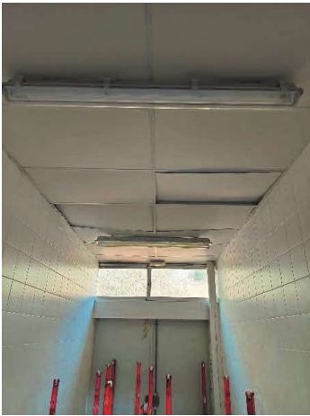
Cel ras en mal estat
