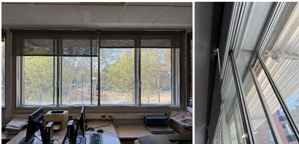
Fusteries a substituir
