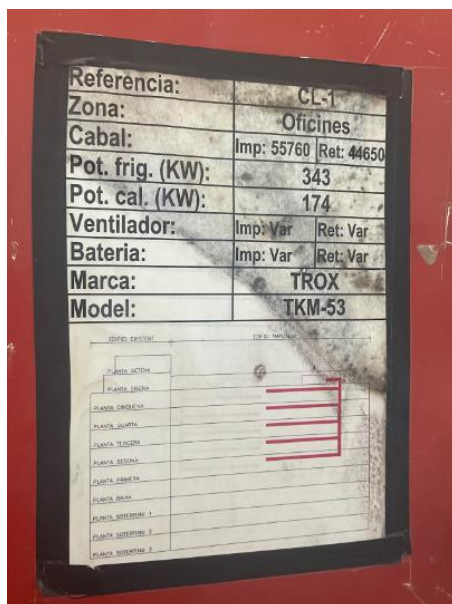
Imatge de la placa de característiques del climatitzador CL-1
