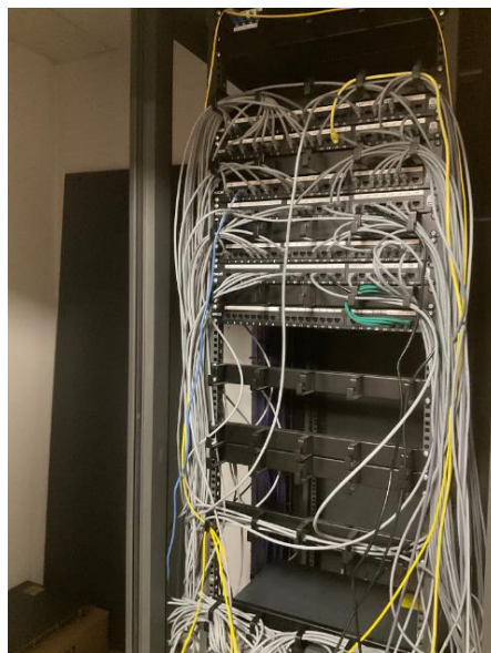
Rack de planta.
