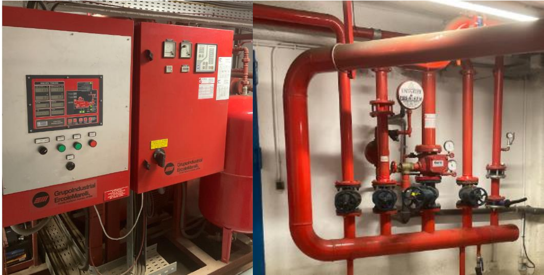
Grup de PCI, col·lector i lloc de control ruixadors.
