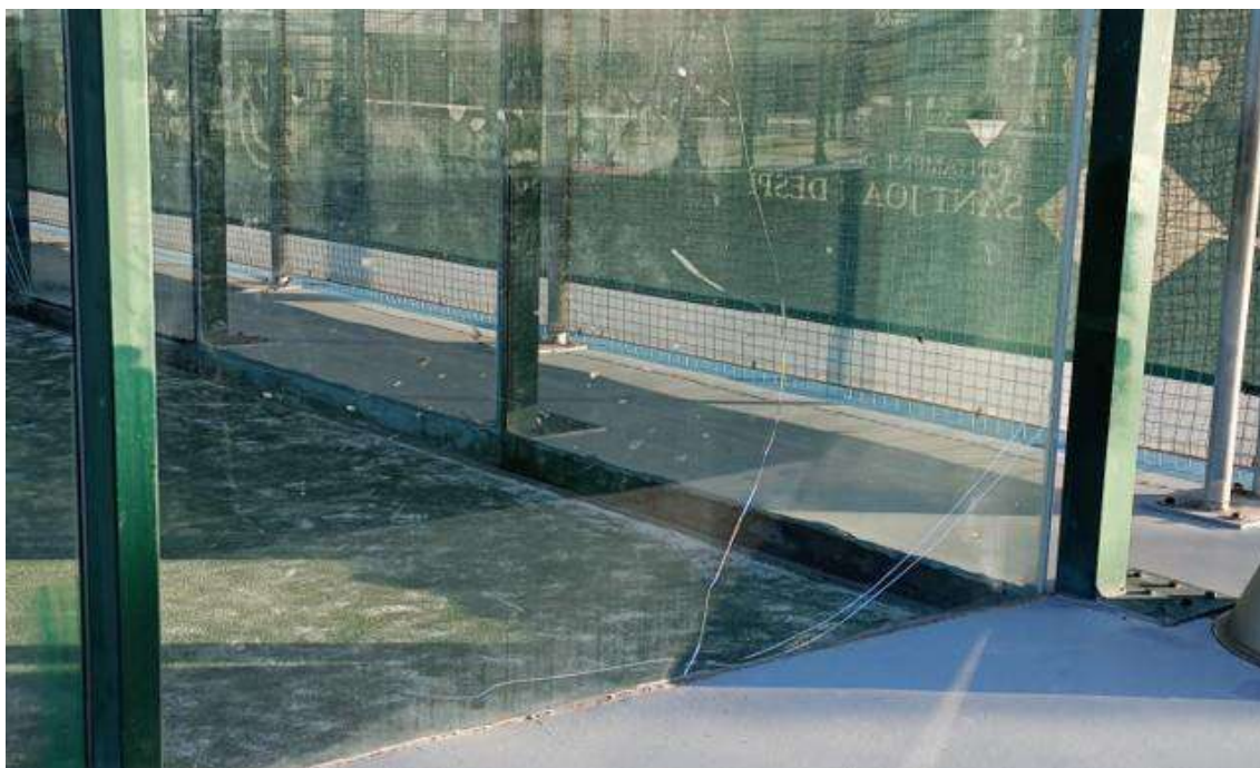
Desperfectes tancament pista de pàdel
