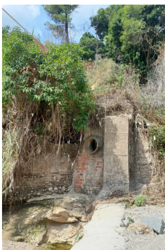
Zona afectada sense desbrossar
