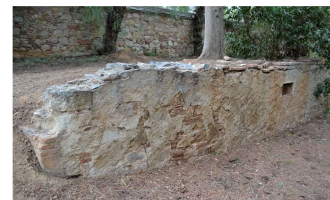
Imatges actuals dels murs i el seu estat de conservació
