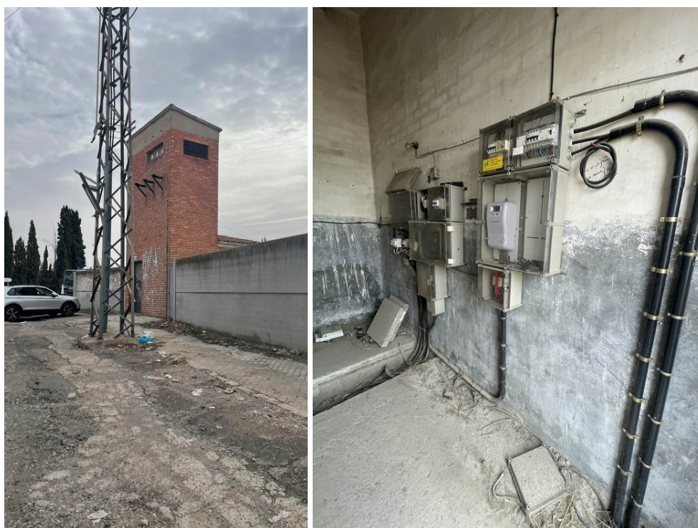
Figura 33. Zona equips de comptatge a l'interior de l'edifici del transformador.
