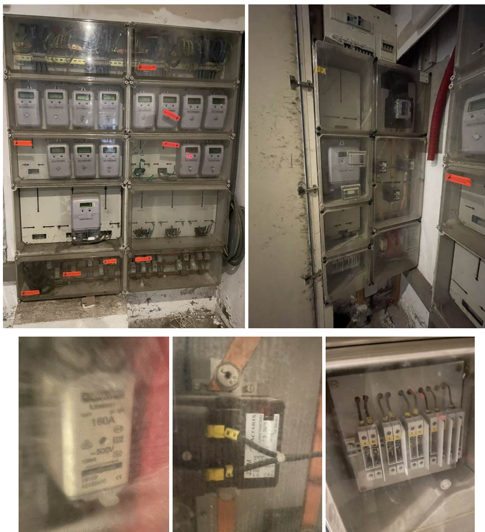
Figura 6. Detalls centralització existent.
