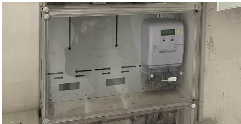
Figura 28. Detalls centralització existent.
