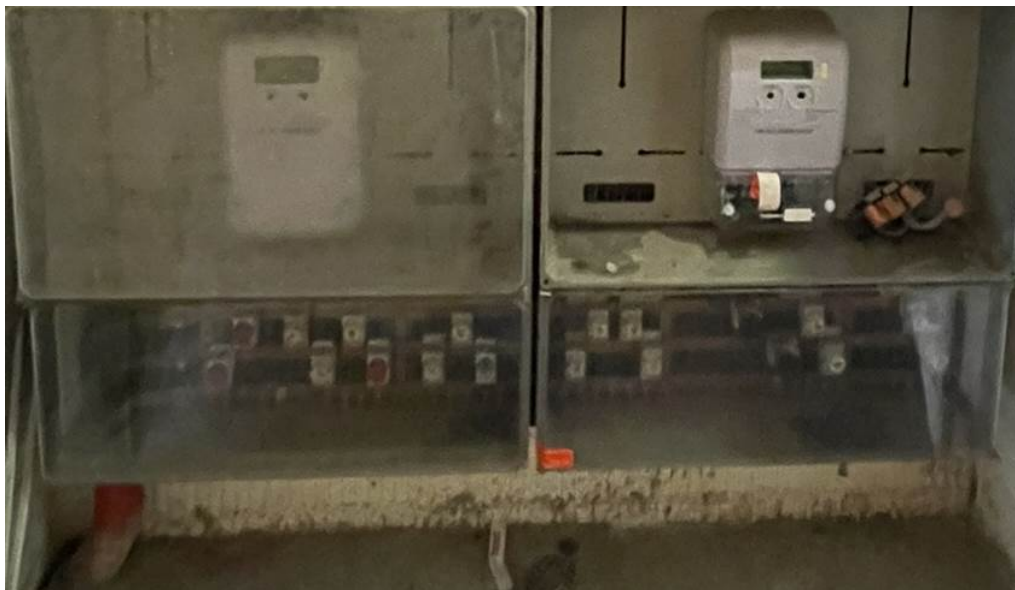
Figura 14. Detalls centralització existent.
