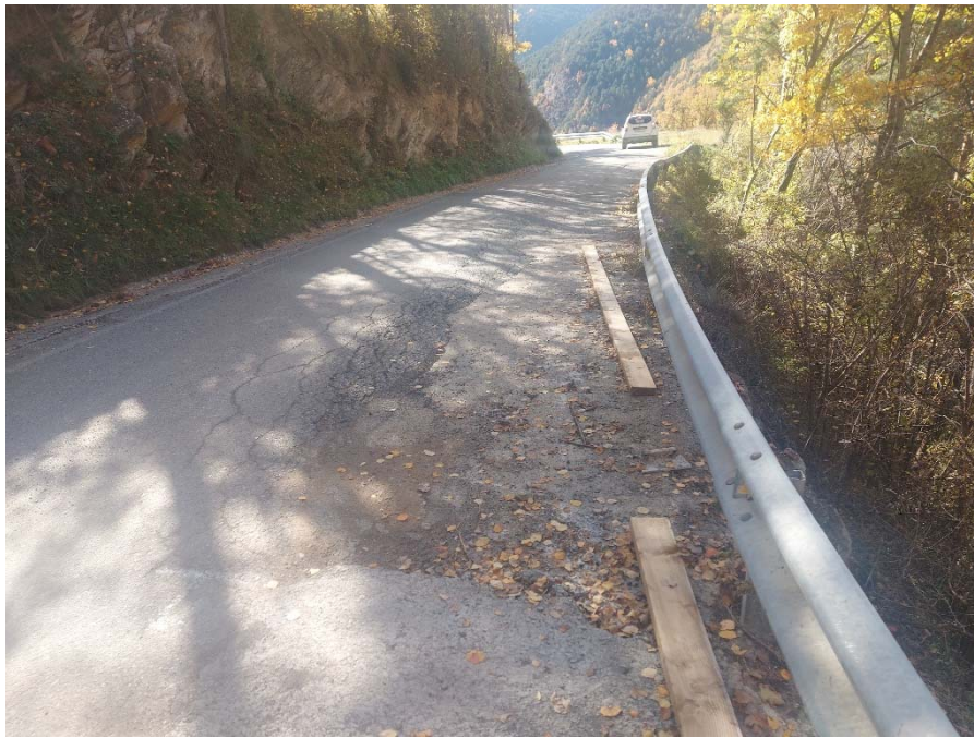
Fotografia núm. 1- actuació superior p.k. 3+100, longitud 27.50 m, amplada 2.60 m
