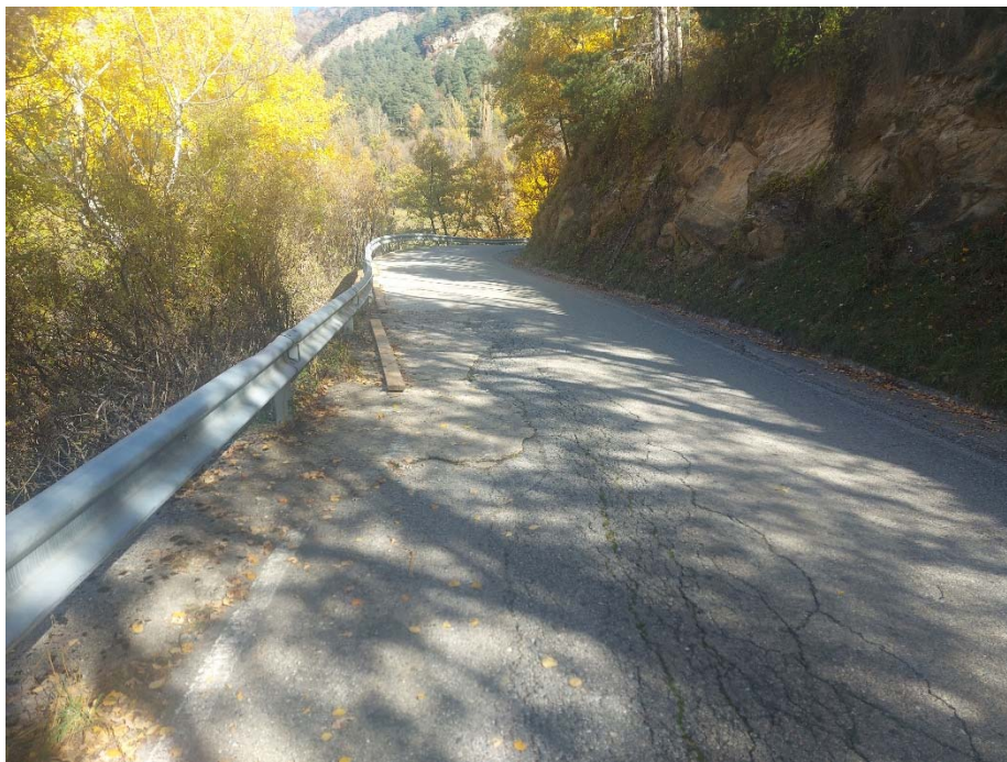
Fotografia núm. 2- actuació superior p.k. 3+100, longitud 27.50 m, amplada 2.60 m
