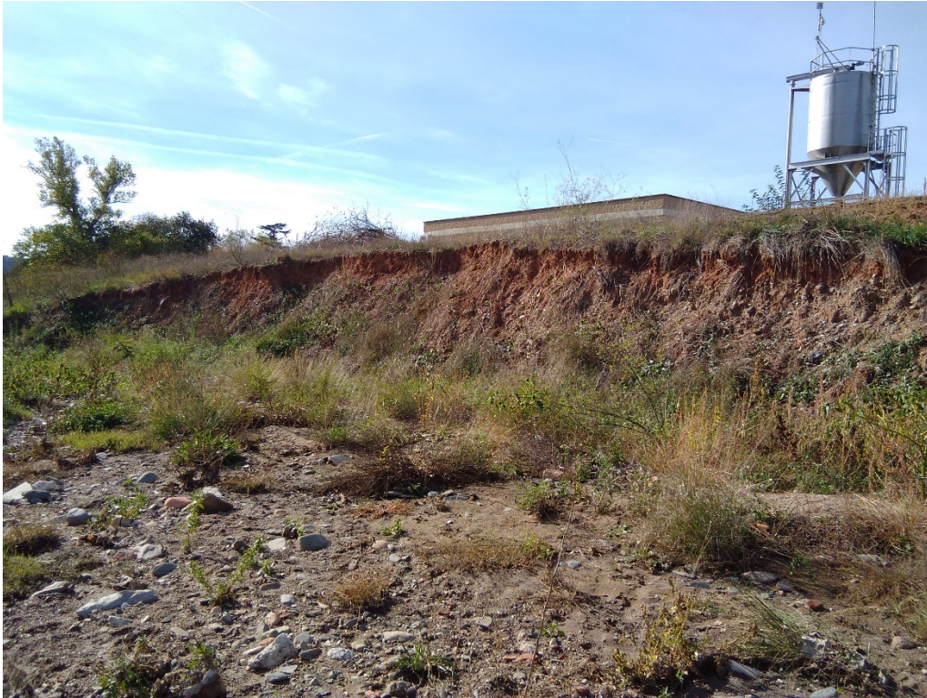
Figura 14 Erosió en un tram del talús del marge dret de la riera de Vallserena. Tram B (vista aigües avall)
