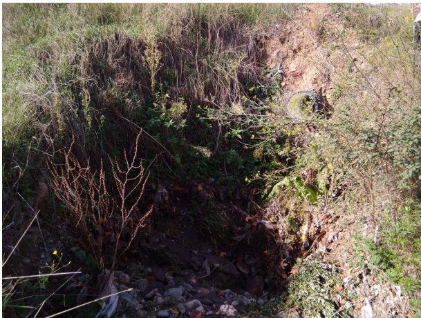
Figura 13 : Imatge de la sortida del sobreeixidor d'aigües residuals
