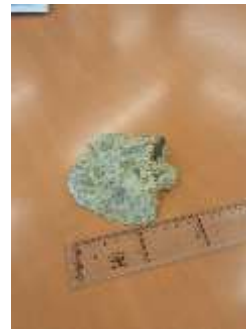
Tros formigó del despreniment
