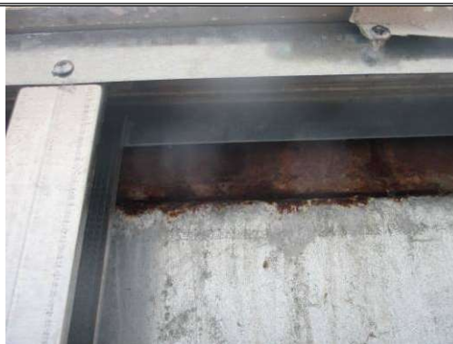
Detalles de la filtración detectada
