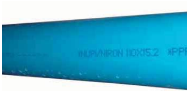
Estado de tubería niron con condensación superficial.
