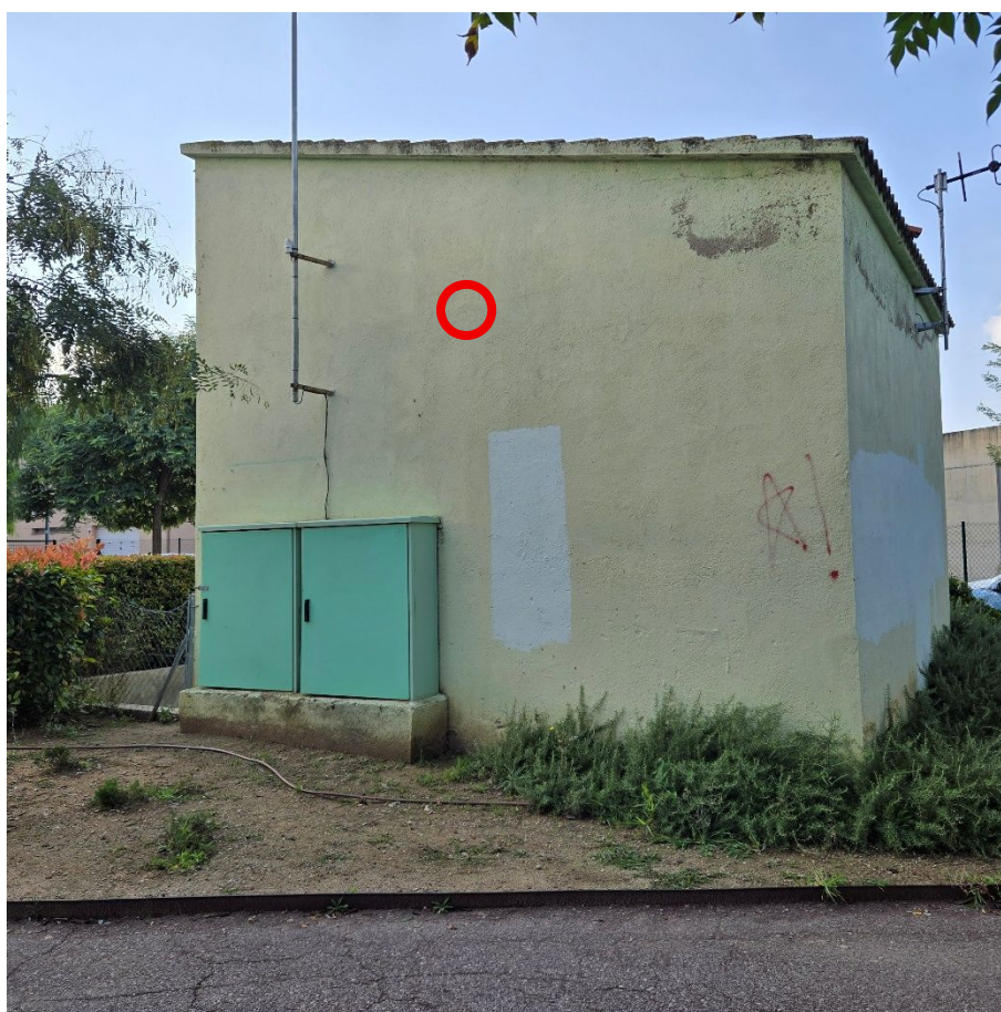
Detall situació armari exterior
