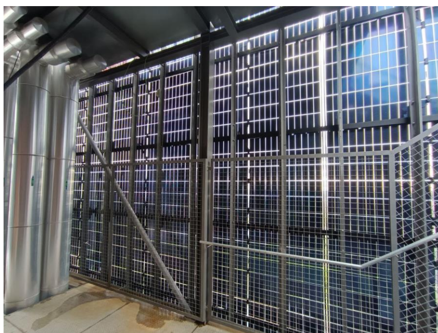
Fig 6. Exemple vista posterior de mòdul Trina Solar TSM-420-NEG9RC.27 en façana.
