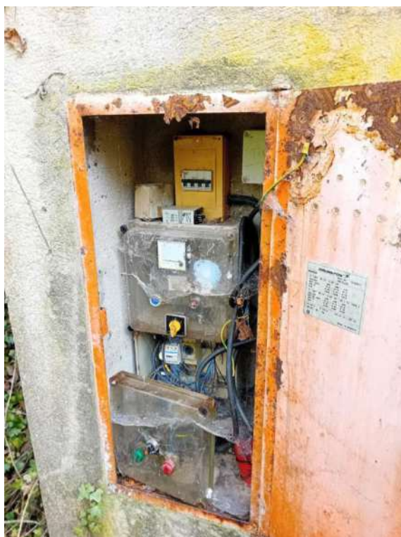
Figura 5. Quadre elèctric del Pou de Can Juncà
