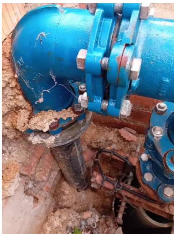
Figura 4. Vista de la canonada de sortida del Pou de Can Juncà
