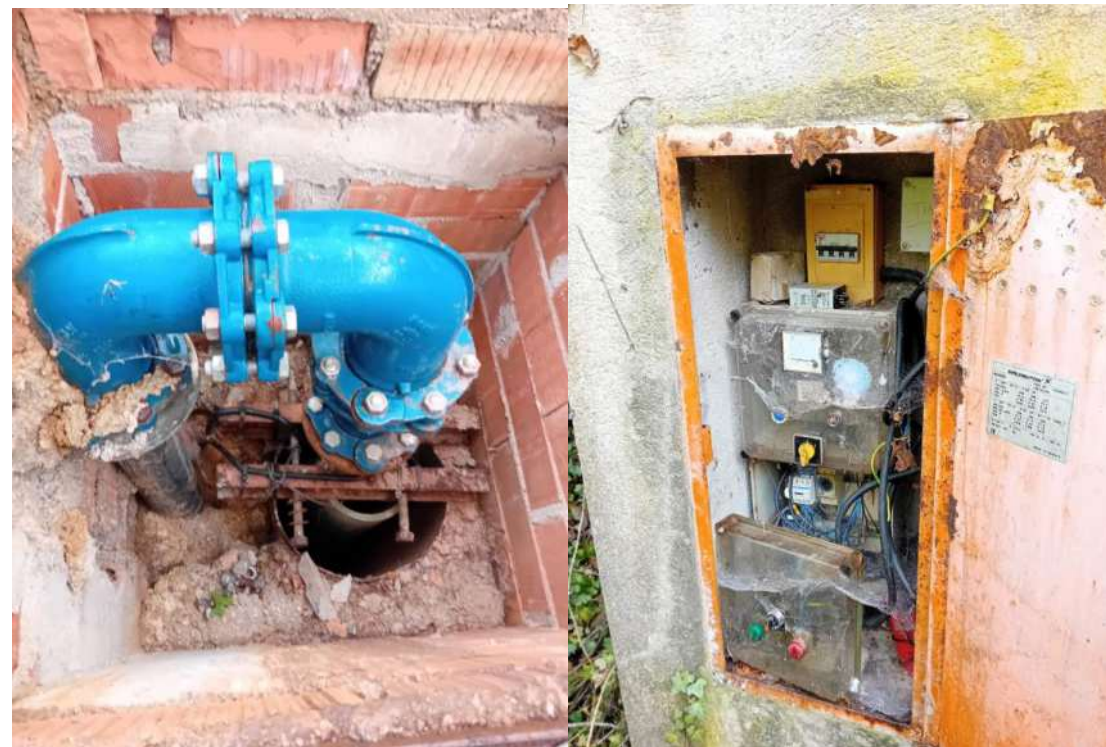
Figura 2. Estat actual de les instal·lacions del pou de Can Juncà.
