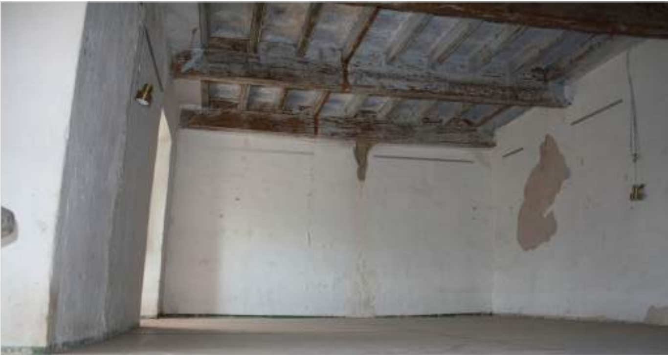
9. Enderroc de paret de maçoneria fruit de les intervencions executades en el moment de la divisió del palau en vivendes. Es pot observar la desconexió de la paret divisoria dels murs de façana, degut a la falta de lligat entre elles. També s'observa que el mur no coincideix amb l'entegnat renaixentista, i que per tant, no existia en la configuració original del palau.
