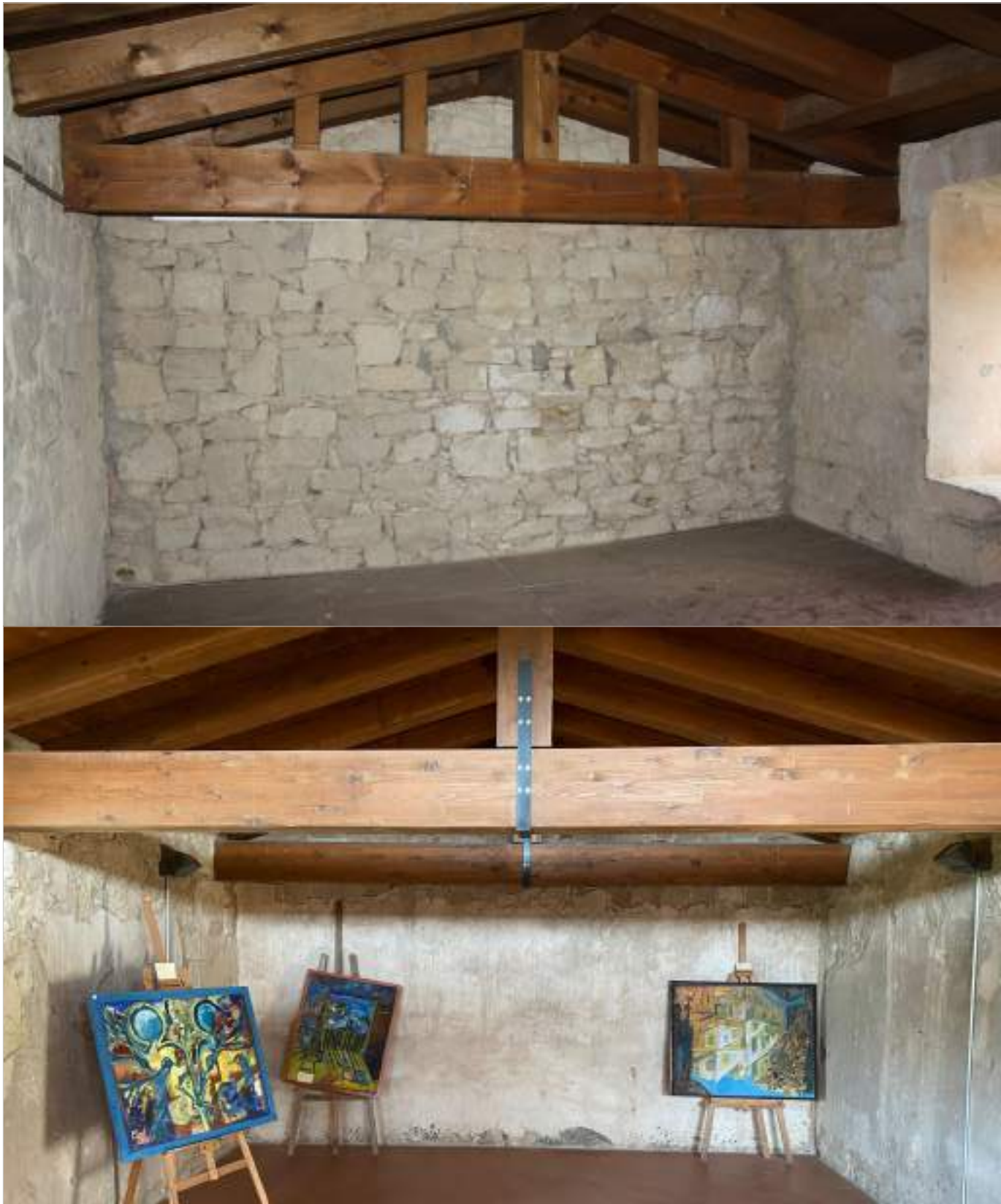
10-11. Enderroc de paret de maçoneria fruit de les intervencions executades en el moment de la divisió del palau en vivendes. Es pot observar la desconexió de la paret divisoria dels murs de façana, degut a la falta de lligat entre elles.
