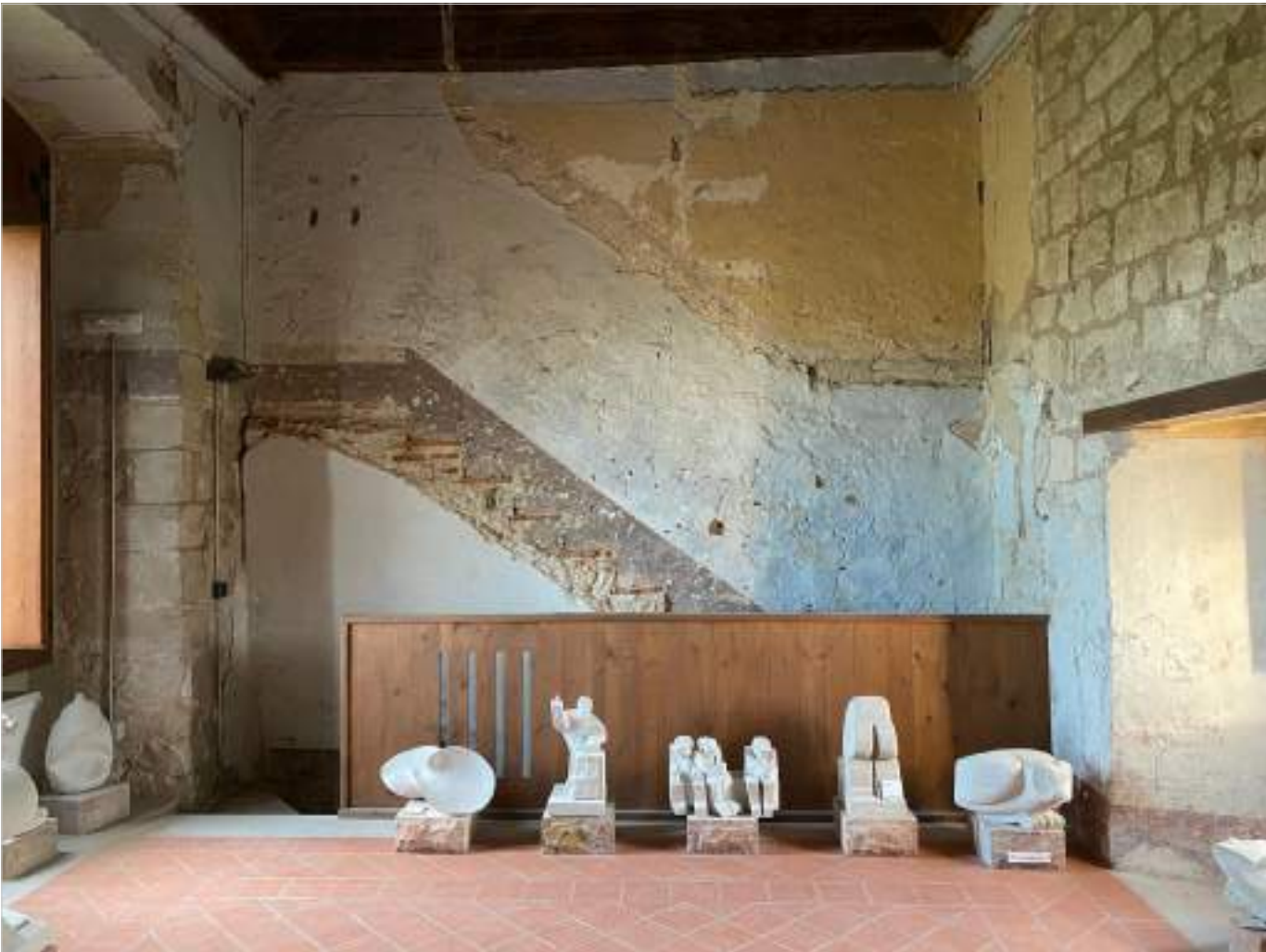
7. Enderroc de paret de maçoneria fruit de les intervencions executades en el moment de la divisió del palau en vivendes. Es pot observar la desconexió de la paret divisoria dels murs de façana, degut a la falta de lligat entre elles. També s'observa que el mur no coincideix amb l'enteginat renaixentista, i que per tant, no existia en la configuració original del palau. Com en el cas anterior, observem la baixa qualitat muraria de la mamposteria, gracies al desprendiment de part del revestiment.
