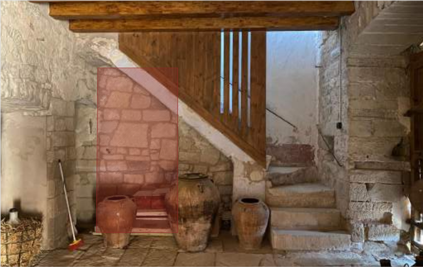
5. Nova obertura de connexió en planta baixa. Es detecta perfectament que es tracta d'un afegit posterior, ja que no existeixen lligades amb el mur de façana original, a més a més de la baixa qualitat murària de la mamposteria, executada mitjançant pedres de tamanys molt diferents, fruit de les intervencions d'autoconstrucció executades en el moment de la divisió del palau en vivendes.
