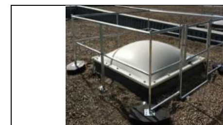
Figura 3. Ejemplo protección claraboyas con barandilla
