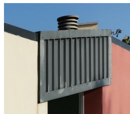
Deteriorament de la xapa metàl·lica de façana
