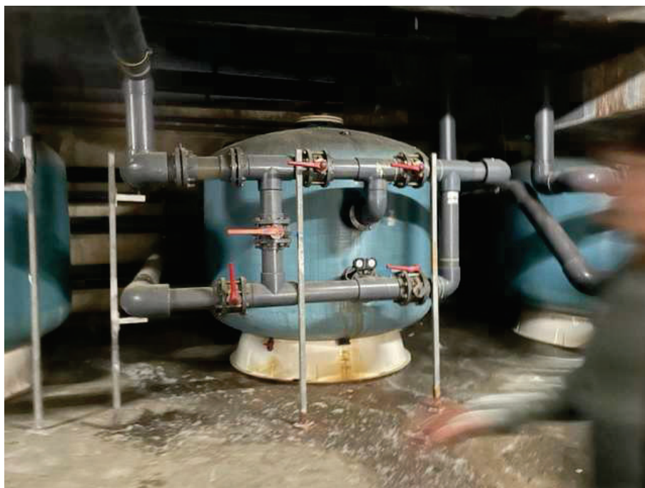
Foto 3. Filtre tipus a substituir
