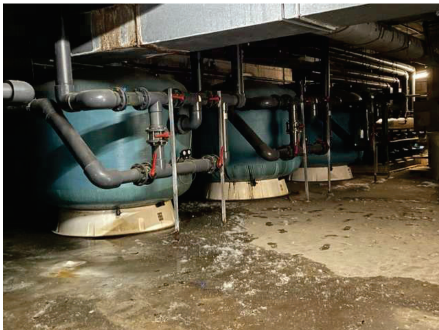
Foto2. Sala amb 3 dels 5 filtres de piscina exterior
